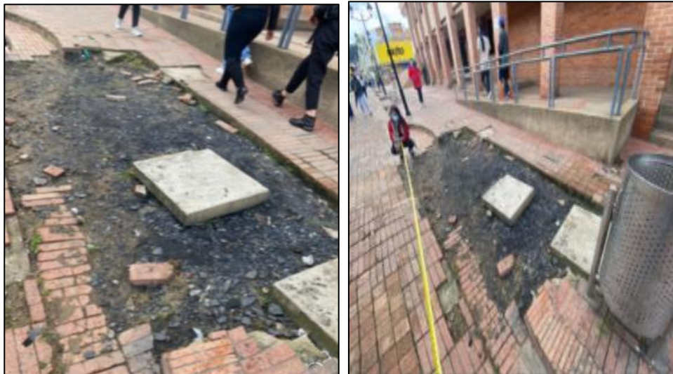
Figura 4 Deterioros de la zona peatonal
