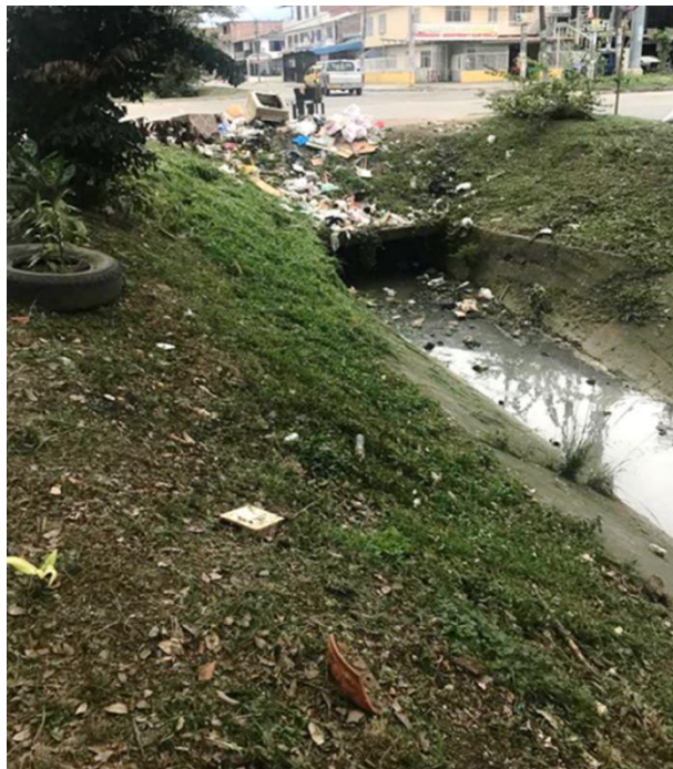
Ilustración 1 Acumulacion de residuos en el canal de aguas lluvias del barrio Unión de Vivienda Popular
