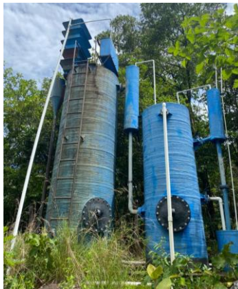
Figura 38. PTAR Vereda Turua sector Centro
