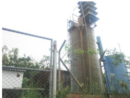
Figura 33. PTAR Vereda Cerritos
