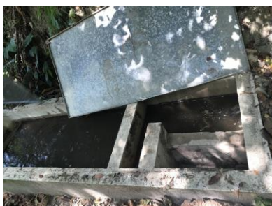
Figura 2. Desarenador, elemento acueducto vereda Cupiagua Sector los Manchegos
