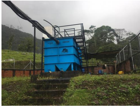
Figura 24. PTAR Vereda Monterralo
