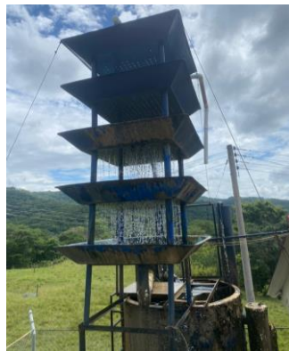
Figura 37. PTAR Vereda Turua
