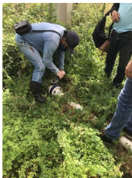
Figura 8. Tubería de polietilenop en la red de distribución, vereda Guaduales
