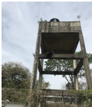
Figura 6. Tanque de abastecimiento de agua potable, vereda Guaduales
