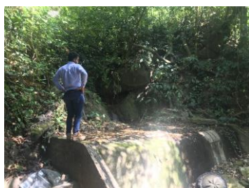
Figura 3. Bocatoma, elemento acueducto vereda Cupiagua Sector los Manchegos
