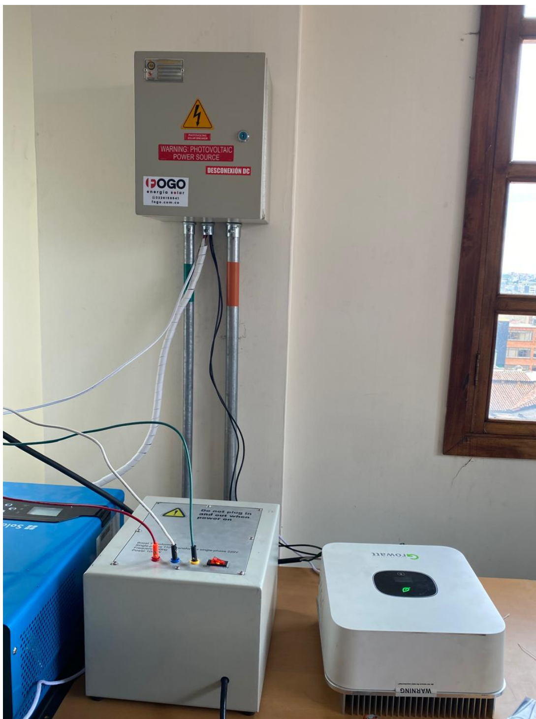
FIGURA 19: Integración del tablero fotovoltaico, transformador e inversor sincronizado con la red (indicador verde). Fuente: Autores.
