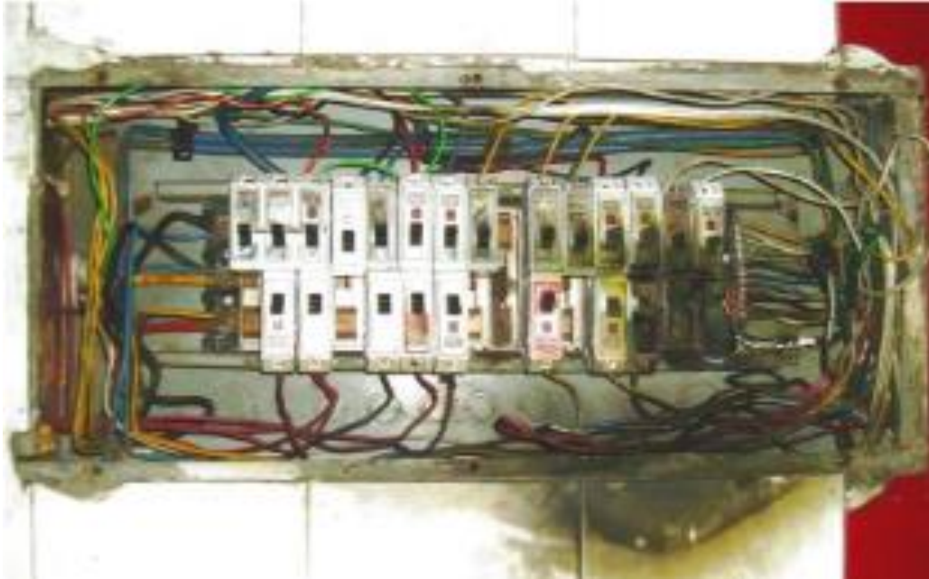
Figura 22. Sobrecarga de los circuitos e instalaciones defectuosas
