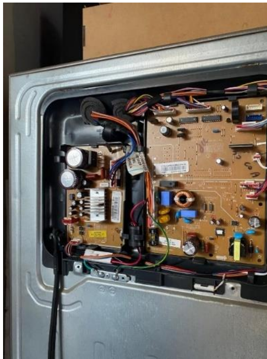
Figura 13. Fusible abierto en tarjeta de control de una nevera
