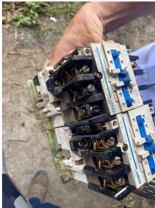
Figura 7. Contactor quemado por ausencia de fase
