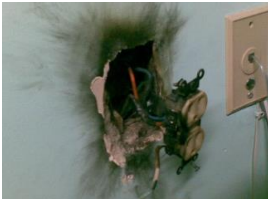
Figura 25. Descarga atmosférica (Rayo) 2
