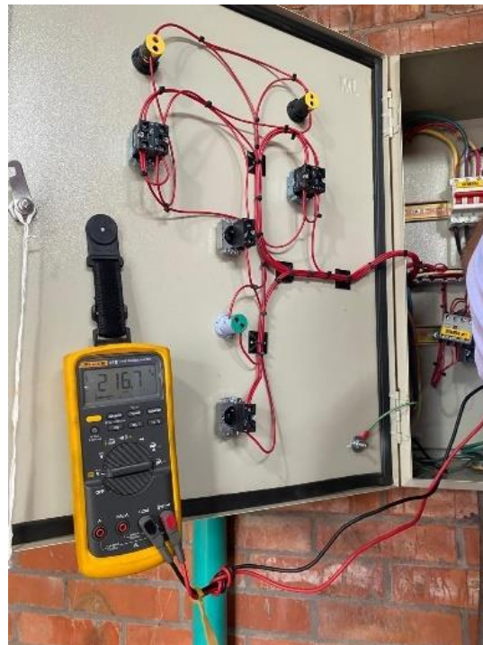
Figura 11. Verificación de fases en correcto estado
