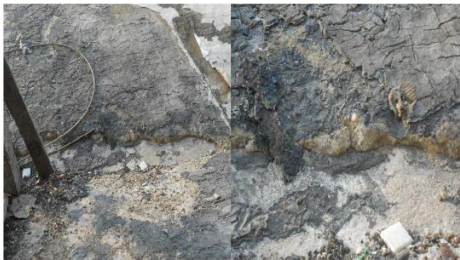
Imagen 9: Desprendimiento de la capa impermeabilizante de la cubierta
