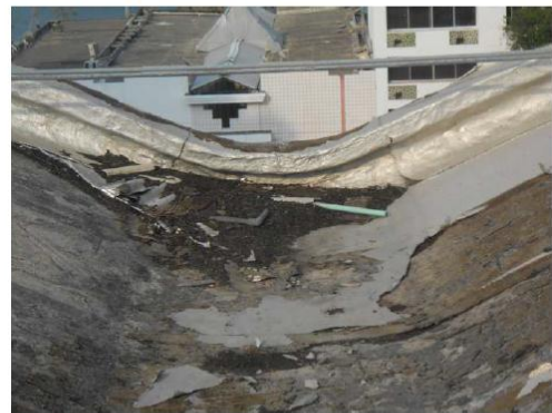
Imagen 7: Taponamiento del sistema de desagüe
