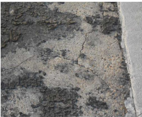
Imagen 5: Fisuras de la Cubierta Abovedada
