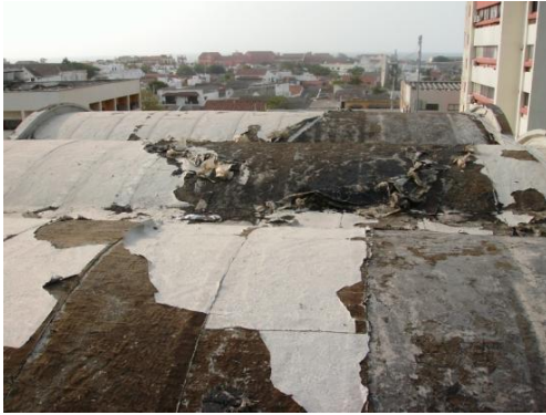
Imagen 4: Desprendimiento del manto Impermeable de la cubierta
