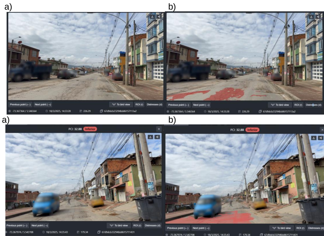
Figura 18. Registros visuales de los segmentos viales con mayor afectación
