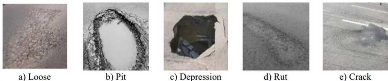
Figura 1. Patologías en pavimentos identificadas mediante técnicas de procesamiento de imágenes con Redes Neuronales Convolucionales (CNN).
