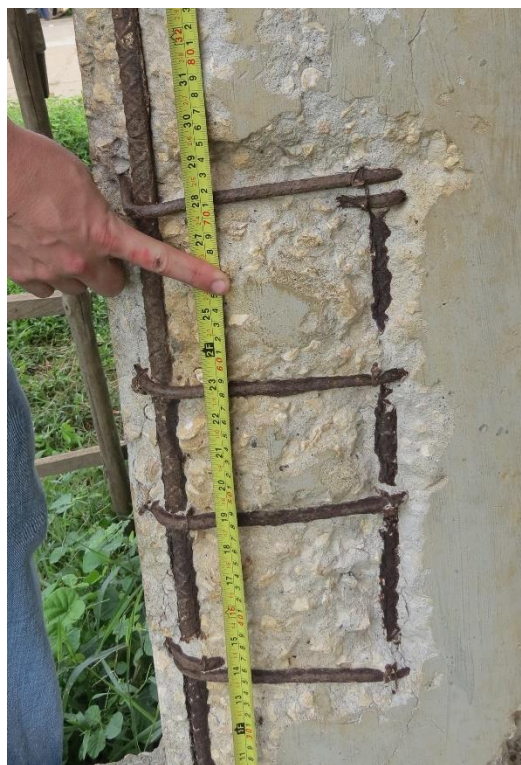
Figura 33 Refuerzo para la categoría: Corrosión superficial (4,0)
