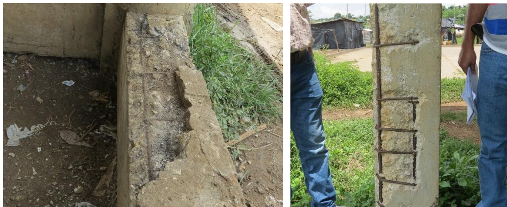
Figura 9 Delaminaciones o desprendimiento del concreto de recubrimiento por corrosión del refuerzo y esfuerzo mecánico antrópico
