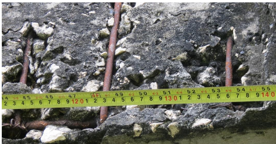
Figura 34 Refuerzo para la categoría: Oxidado-Superficialmente oxidado (3,0)
