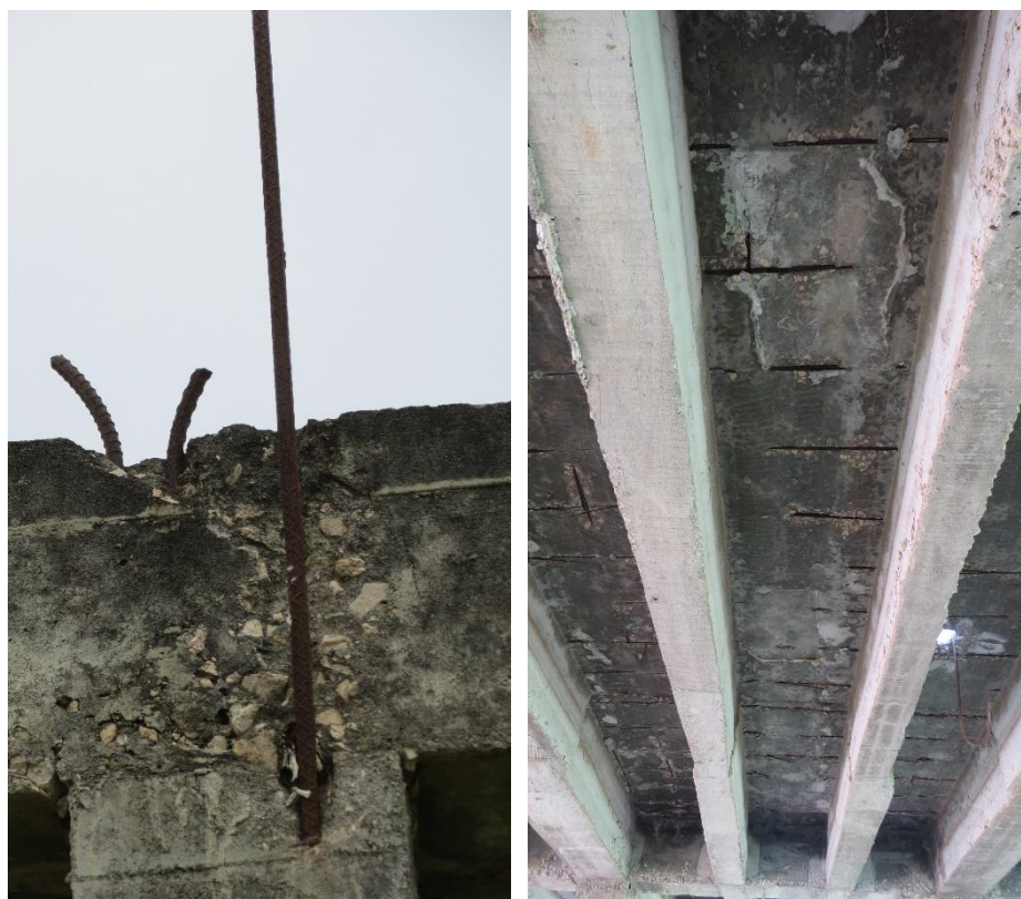
Figura 10 Acero de refuerzo expuesto y oxidado/corroído
