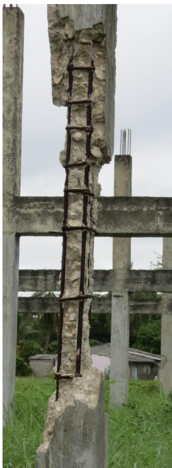
Figura 35 Refuerzo para la categoría: Corrosión Severa (5,0)
