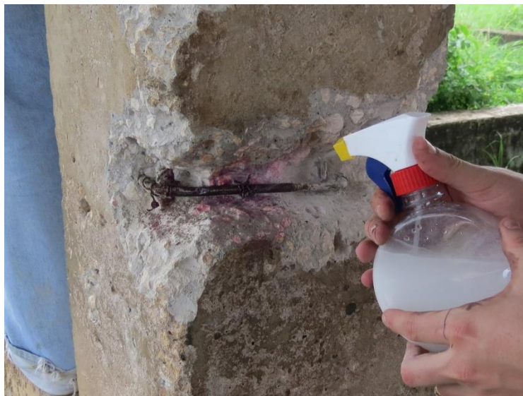
Figura 32 Refuerzo para la categoría: Parcialmente oxidado (2,0)
