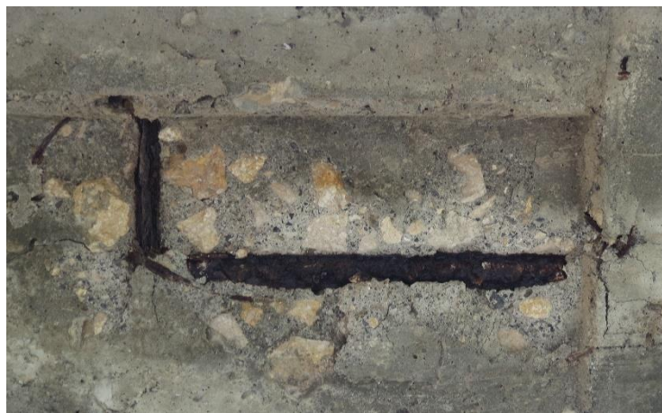
Figura 31 Refuerzo para la categoría: Corrosión superficial (4,0)
