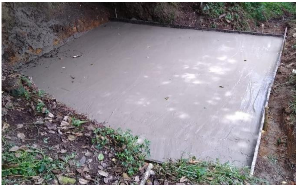
Ilustración 46: Acueducto El Rubí placa en concreto.
