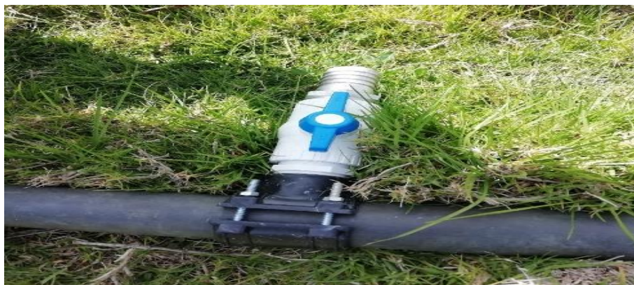
Ilustración 41: Suministros acueducto El Regadero.
