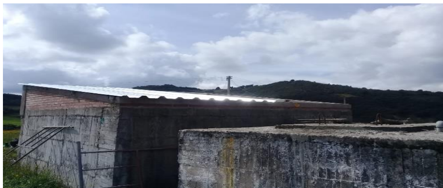
Ilustración 23: Tanque acueducto el Rabanal
