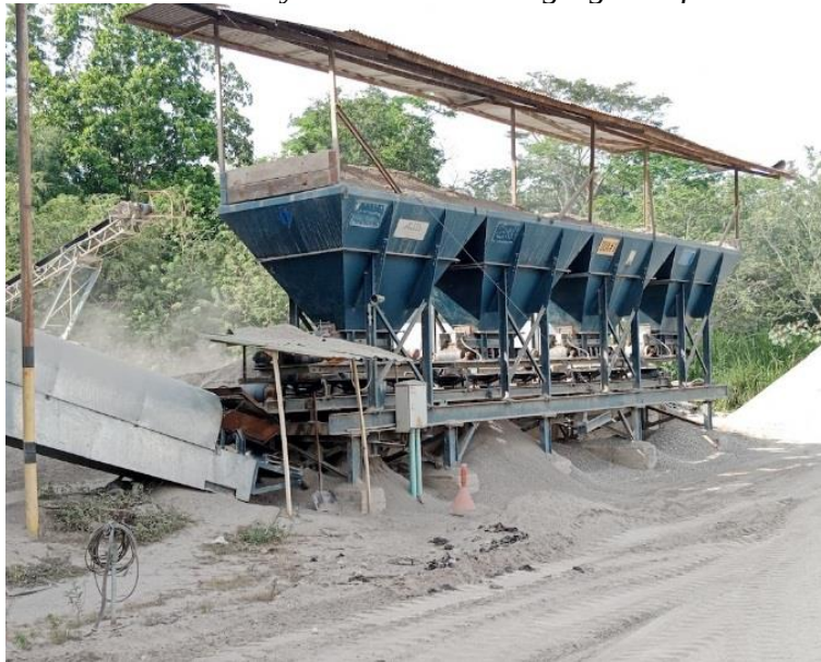
Figura 10. Tolvas de almacenamiento y distribución de agregados pétreos
