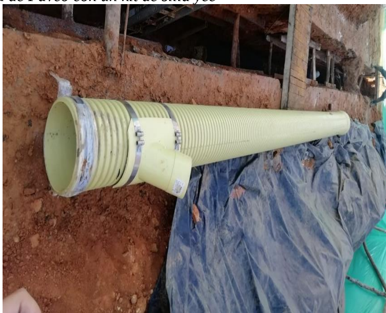
Figura 33. Tubería de Pavco con un kit de silla yee
