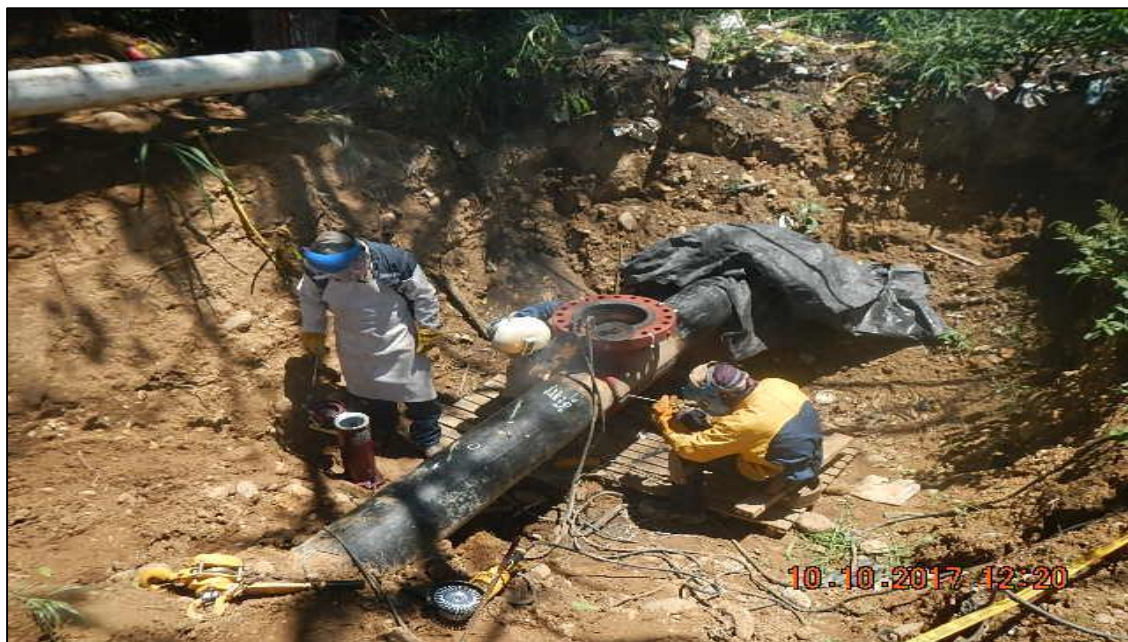
Figura 31. Instalación Tee para bypass Fuente Autor
