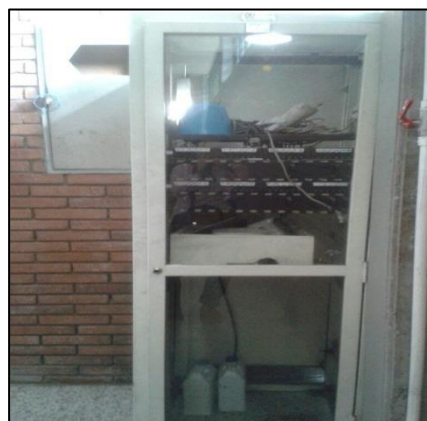
Imagen 9 Maquina en desuso
