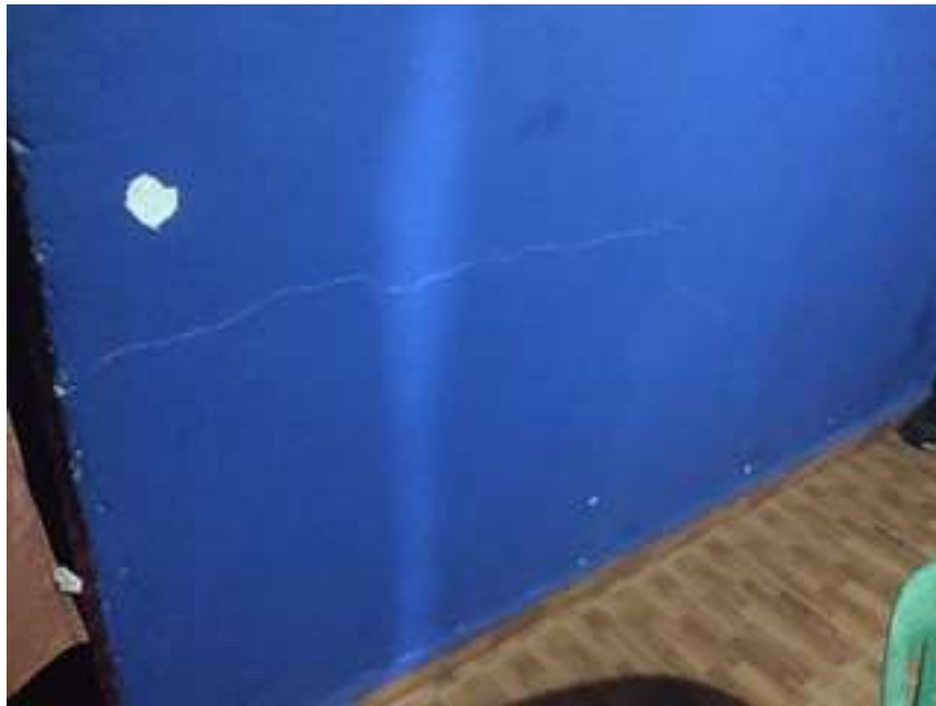
Ilustración 13. Fisuras internas (Mosquera, 2020).
