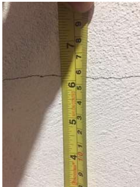
Ilustración 12. Fisuras internas (Mosquera, 2020).
