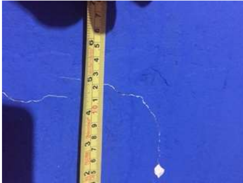
Ilustración 13. Fisuras internas (Mosquera, 2020).
