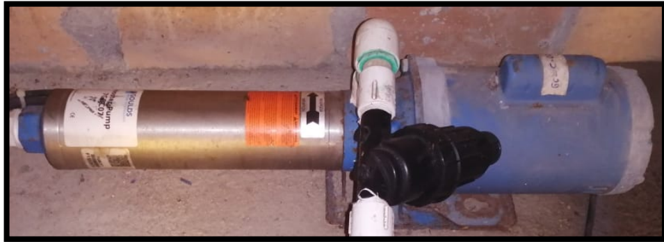
Ilustración 46. Bomba Foggers controlada.
