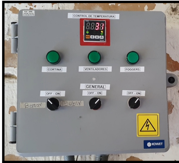
Ilustración 48. Control automático instalado desactivado.
