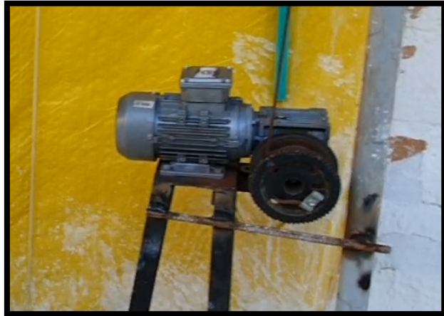
Ilustración 44. Moto reductor instalado.
