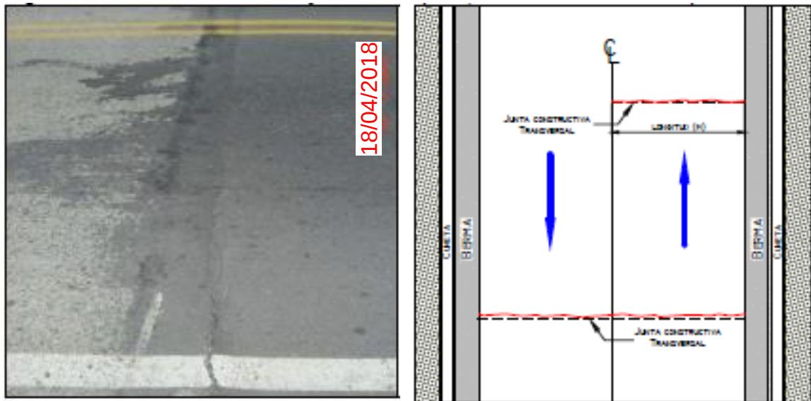
Figura 6: Fisura transversal en junta de construcción (FCT, Unidad de medida: m)
