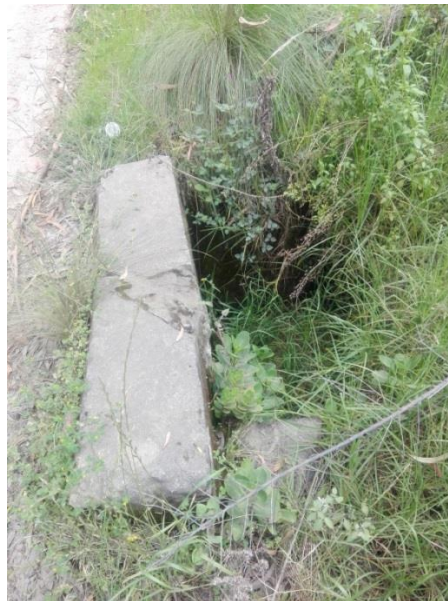
Figura 13: Alcantarilla con falla y presencia de vegetación
