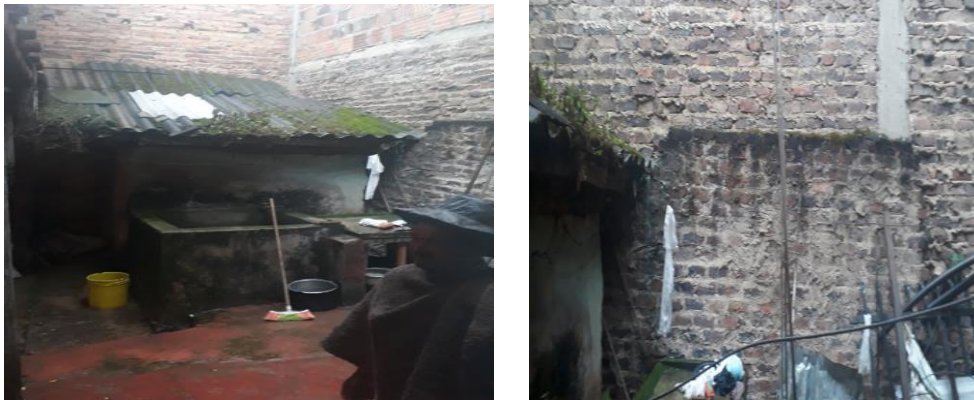
Ilustración 13 Humedad en vivienda del propietario afectante.
