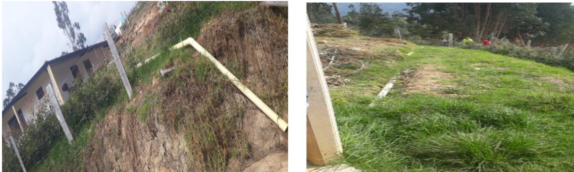
Ilustración 10 Vivienda afectada por el mal manejo de aguas lluvias.
