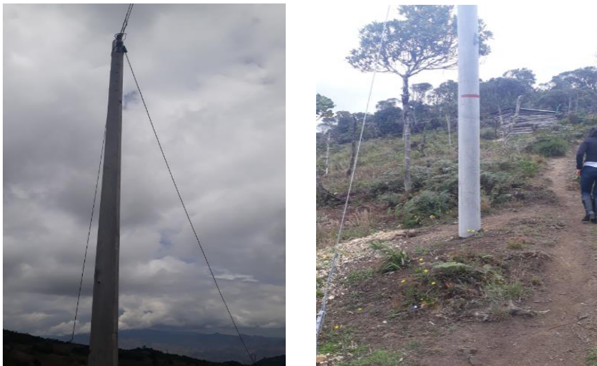
Ilustración 11 Red de distribución de energía eléctrica en viviendas de veredas del municipio.
