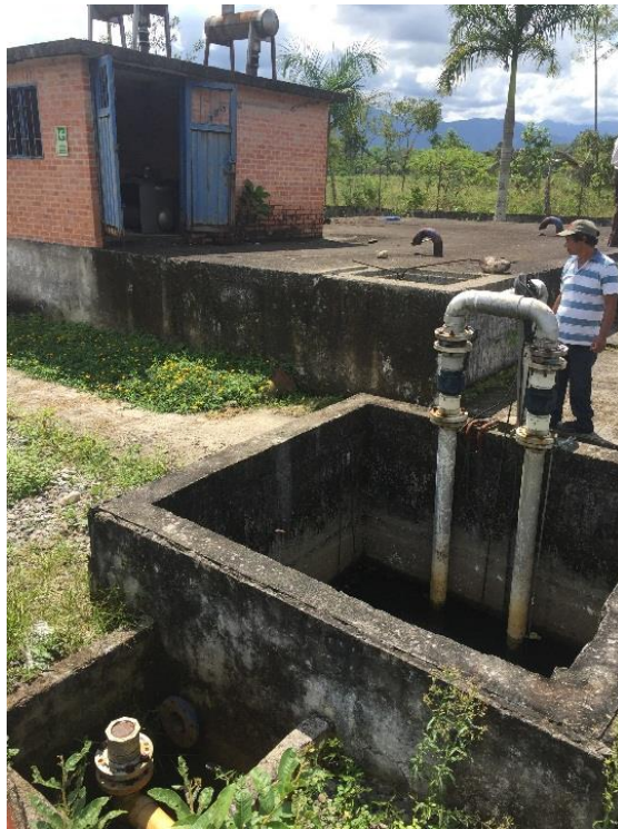
Ilustración 6 Pozo de Bombeo de Lodos; Tomada por Empresas de servicios públicos del Meta (EDESA S.A E.S.P., 2016)
