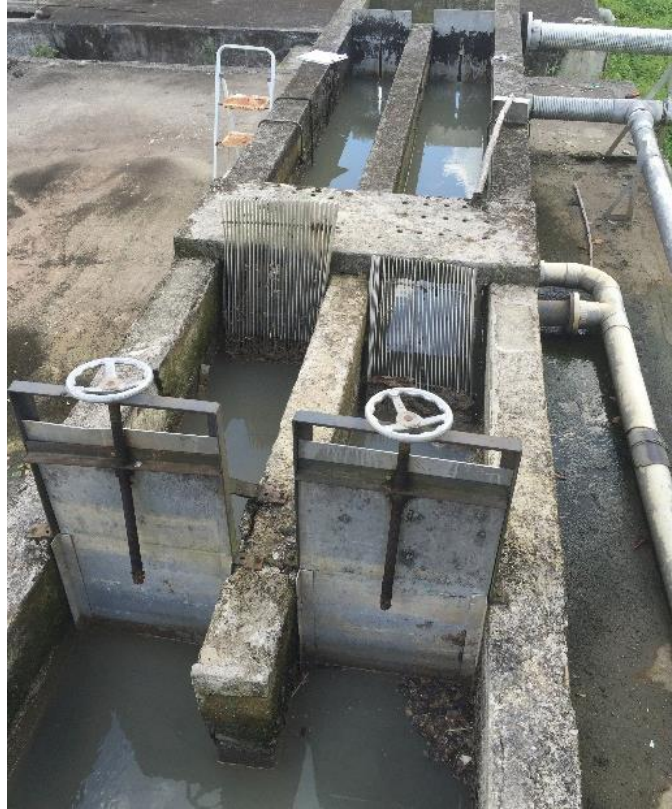
Ilustración 4 Desbaste y Desarenador; Tomada por Empresas de servicios públicos del Meta (EDESA S.A E.S.P., 2016)
