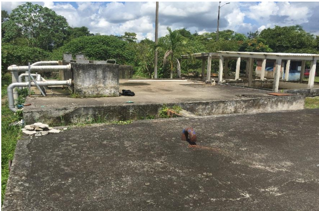
Ilustración 3 reactores UASB; Tomada por Empresas de servicios públicos del Meta (EDESA S.A E.S.P., 2016)
