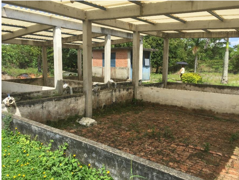
Ilustración 8 Lecho de Secado De Lodos; Tomada por Empresas de servicios públicos del Meta (EDESA S.A E.S.P., 2016)
