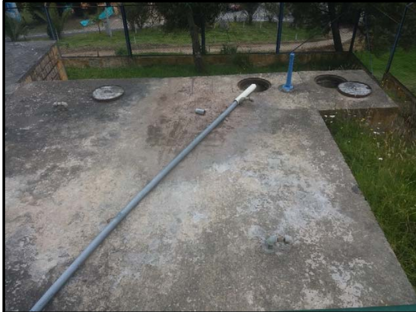
Figura 17. Tanque de almacenamiento
