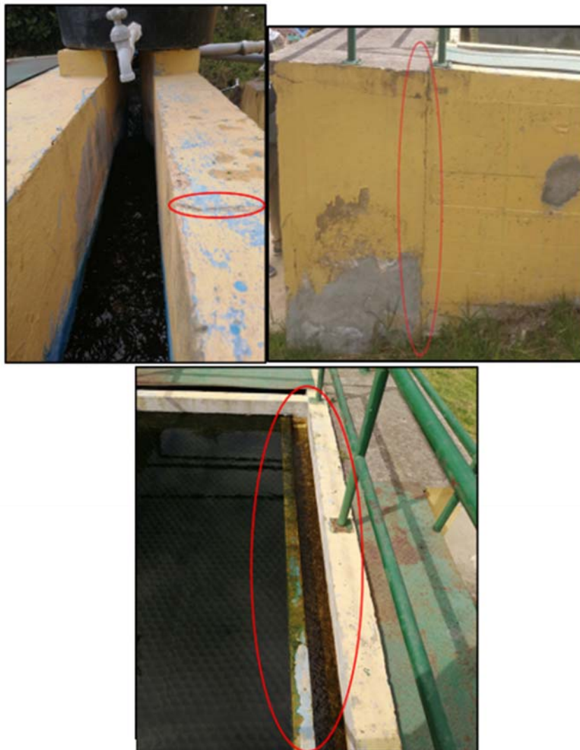
Figura 23. Grietas y moho
