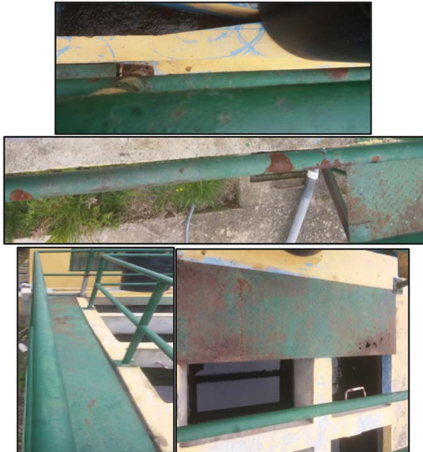
Figura 21. Elementos corroídos PTAP Zipacón
