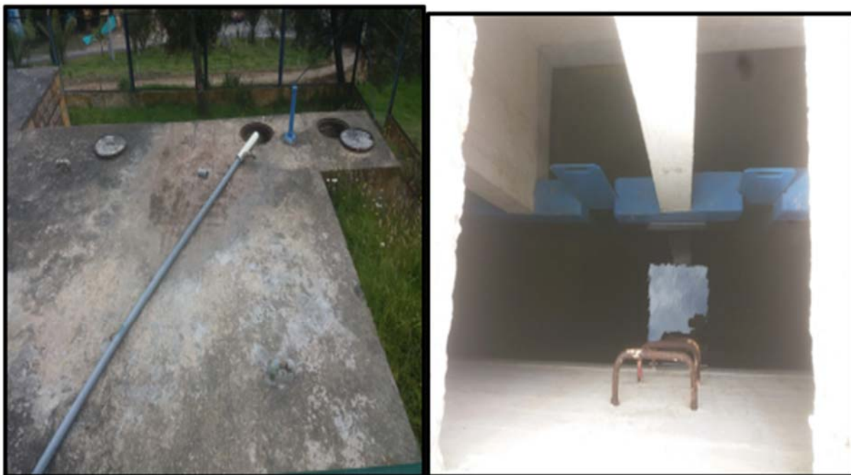
Figura 9. Tanque de almacenamiento y cámara de filtros
