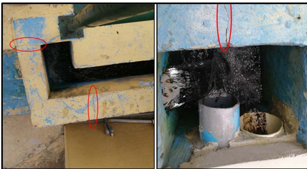
Figura 22. Grietas PTAP Zipacón
