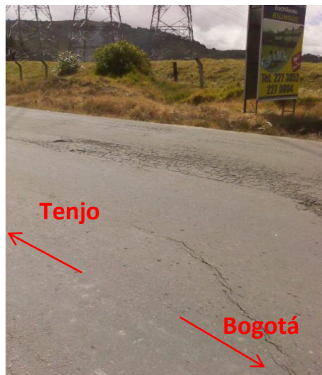
Figura 24: Patologías en la carpeta asfáltica, Piel de Cocodrilo, sondeo 1
