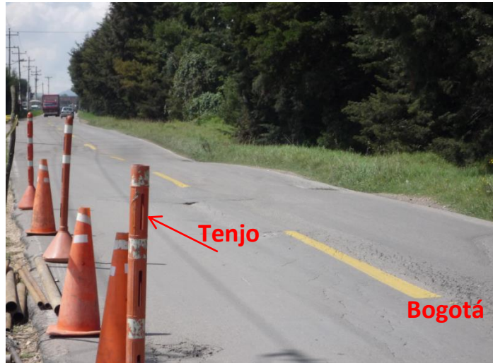
Figura 25: Patología en la carpeta asfáltica, ondulaciones y piel de cocodrilo, sondeo 2
