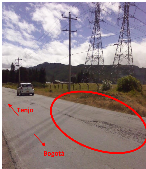
Figura 2. Patologías del pavimento flexible.
