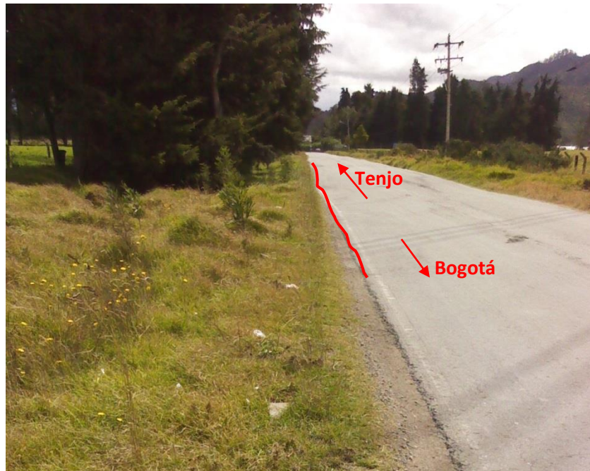
Figura 3: Patologías en la carpeta asfáltica
