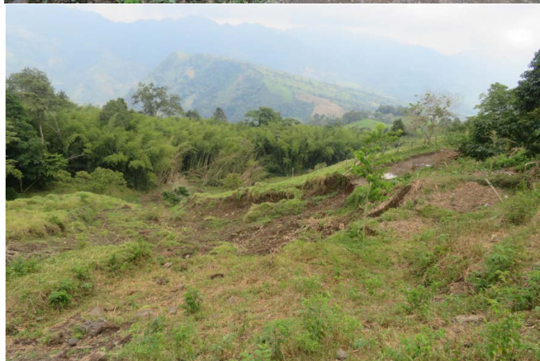
Ilustración 61. Parte superior del proceso de remoción Vista desde el flanco izquierdo del movimiento; la banca de la vía veredal se perdió totalmente y el proceso tiene tendencia retrogresiva Sitio Crítico 30 Fuente: Geocing S.A.S.
