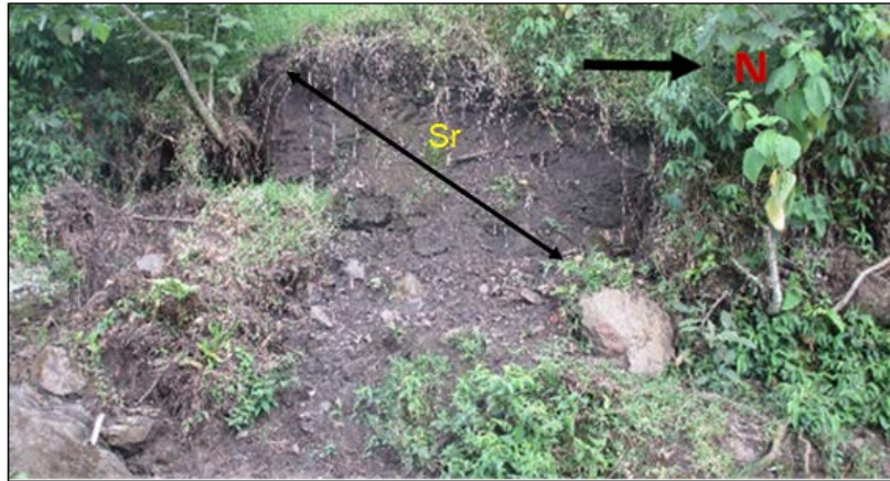
Ilustración 5. Suelo residual (Sr). (Roca parental lutitas, altamente meteorizadas. Obsérvese movimiento de inestabilidad de magnitud puntual.) (Coordenadas, E: 956.885 / N: 1099685) Fuente: Geocing S.A.S.
