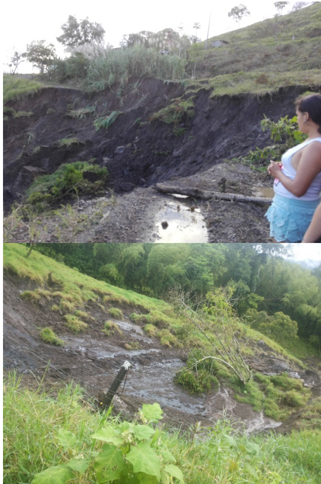
Ilustración 75 Pérdida de la banca por problemas de inestabilidad de taludes asociados a la saturación del talud, expresados en mecanismos de falla complejos evolucionados en flujos. Fuente: Elaboración propia
