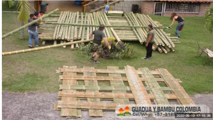
Figura 116. Correcta preservación de elementos en guadua al recibo.
