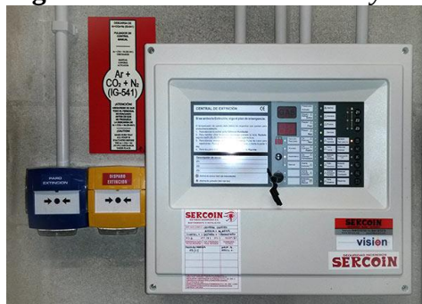
Figura 232. Central de control y señalización de incendios.
