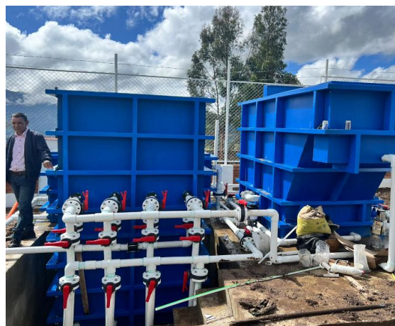
Fuente: Tomado de Informe de Empalme EPB (2025).
