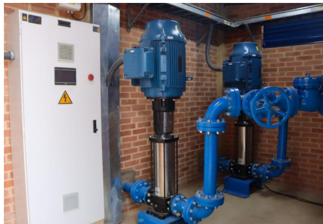
Fuente: Tomado de Informe de Empalme EPB (2025).
