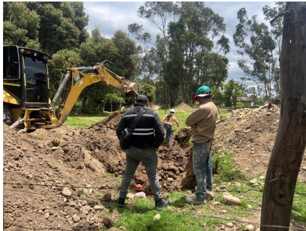
Fuente: Tomado de Informe de Empalme EPB (2025).
