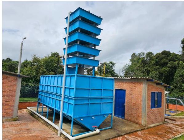
Fuente: Tomado de Informe de Empalme EPB (2025).
