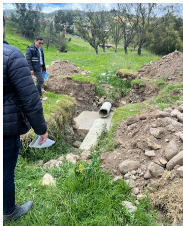
Fuente: Tomado de Informe de Empalme EPB (2025).
