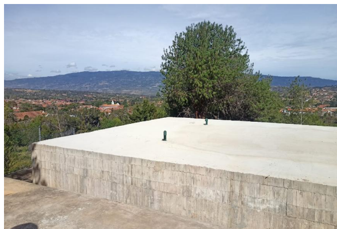
Fuente: Tomado de Informe de Empalme EPB (2025).
