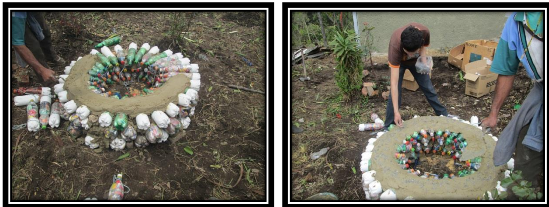
Foto N° 38 y 39. Se cubre con cemento las botellas, dejando la parte inferior expuesta, se deja liso con un palustre, y si se desea se puede decorar con objetos antes que el cemento se seque por completo.
