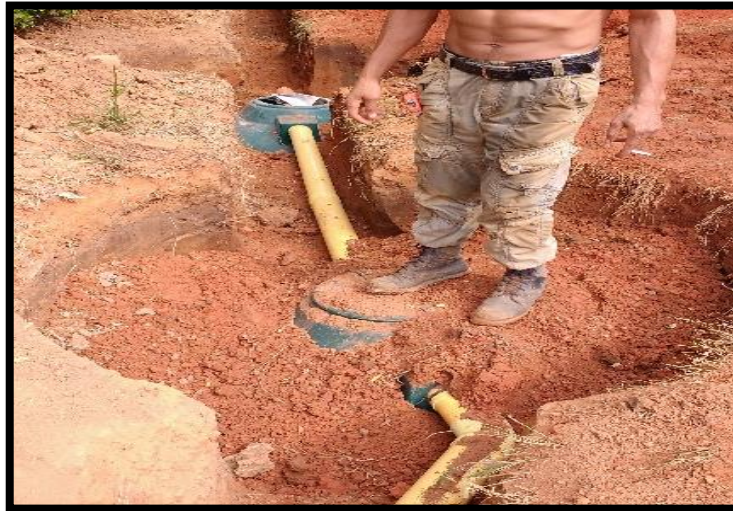
Pozo séptico sustituto
