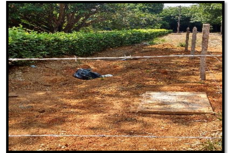
Funcionamiento del nuevo pozo séptico
