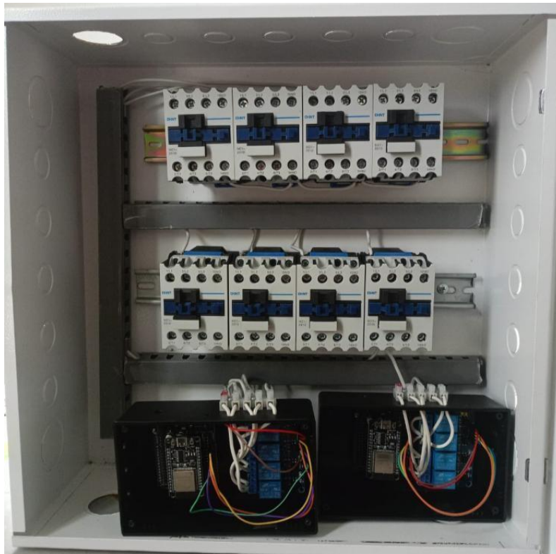
Figura 9. Tablero de automatización
