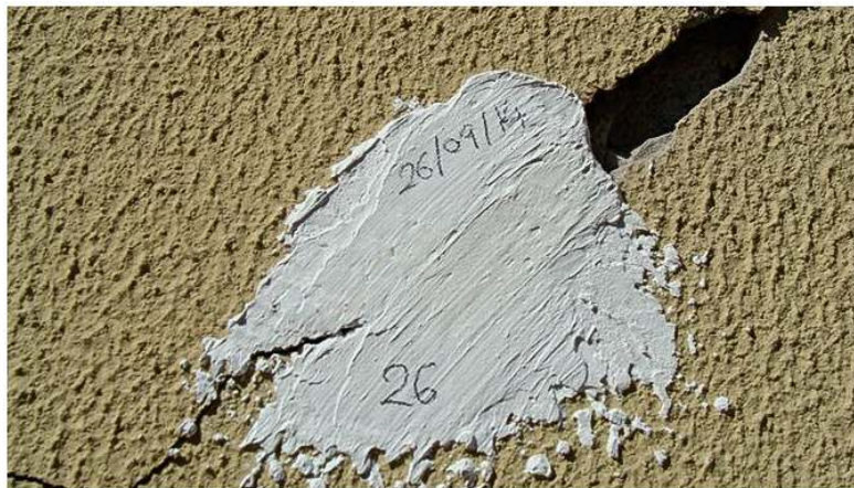
Figura 38 Testigo de Yeso. (Patología + Rehabilitación + Construcción., 2021)
