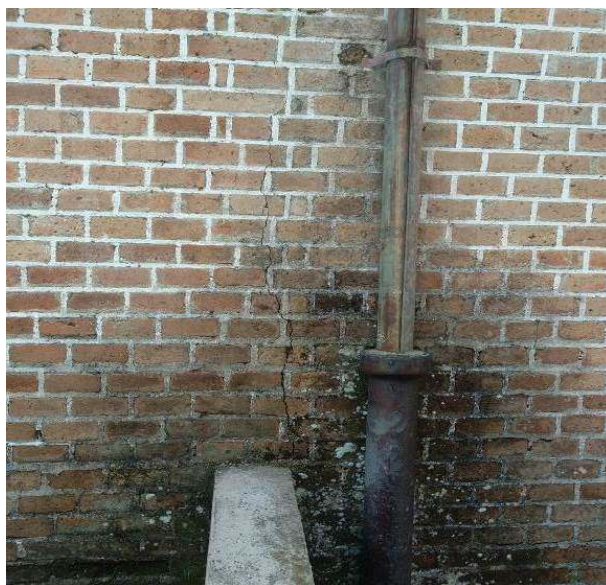
Figura 17 Humedad Accidental Bajante. Fuente Propia
