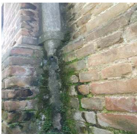
Figura 18 Humedad Accidental Bajante. Fuente Propia
