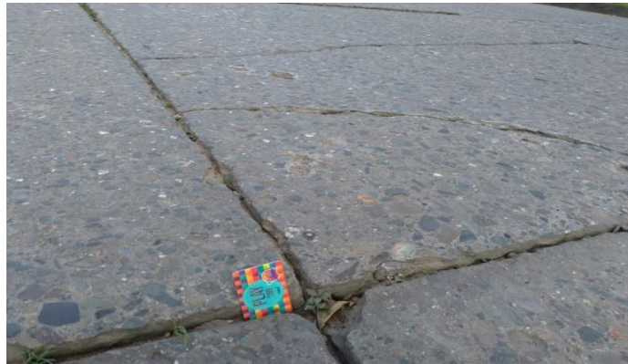
Ilustración 16 Daño de sellos
