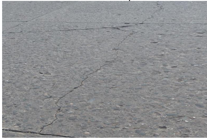
Ilustración 15. Fisuración por Durabilidad
