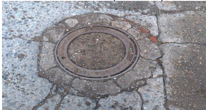
Ilustración 23. Grieta en pozo de inspección
