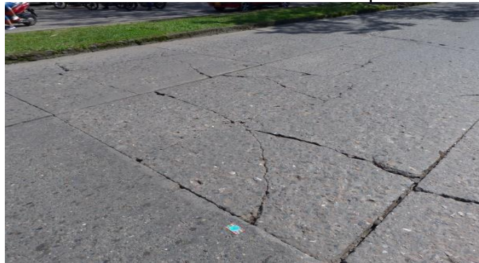
Ilustración 11 Grieta en Bloque
