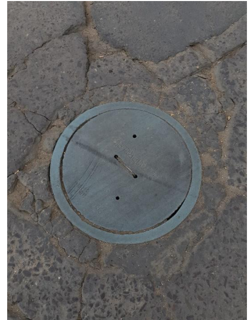
Fotografía 13. Grieta en sumidero
