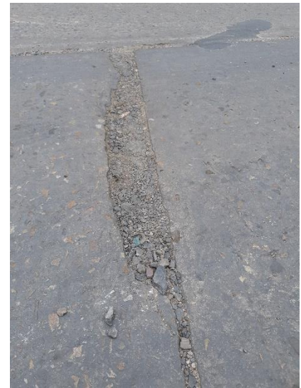
Fotografía 14. Desportillamiento de junta
