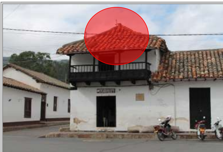
FIGURA N. 64. Identificación principales lesiones a nivel de cubierta a nivel de segundo piso. Fuente: Grupo de investigación.
