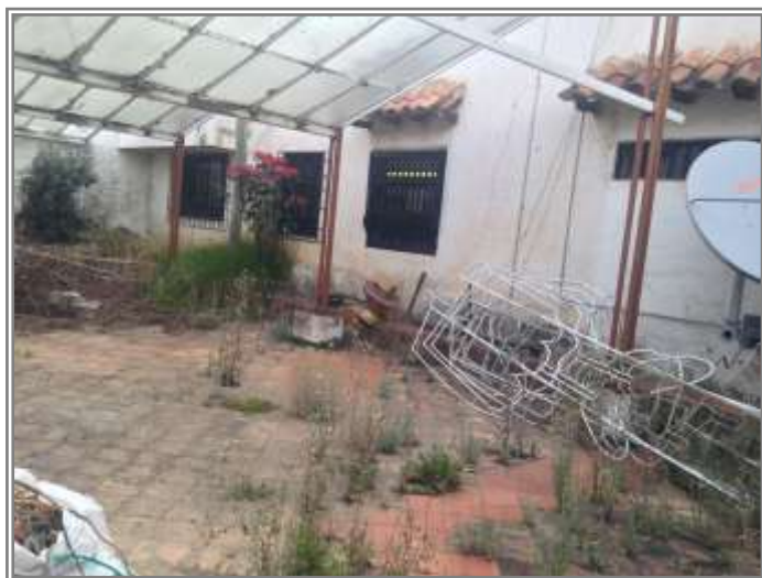
FIGURAS N. 54 y 55. Estado elementos estructurales metálicos espacio E1-8. Fuente: Grupo de investigación
