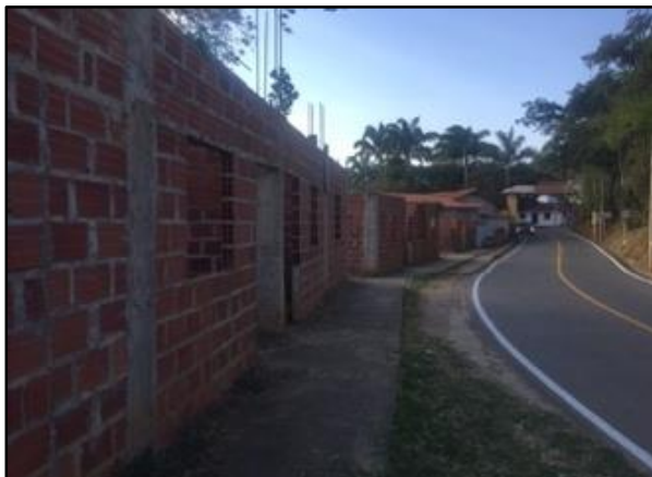
Figura 58. Infracción Urbanística Barichara
