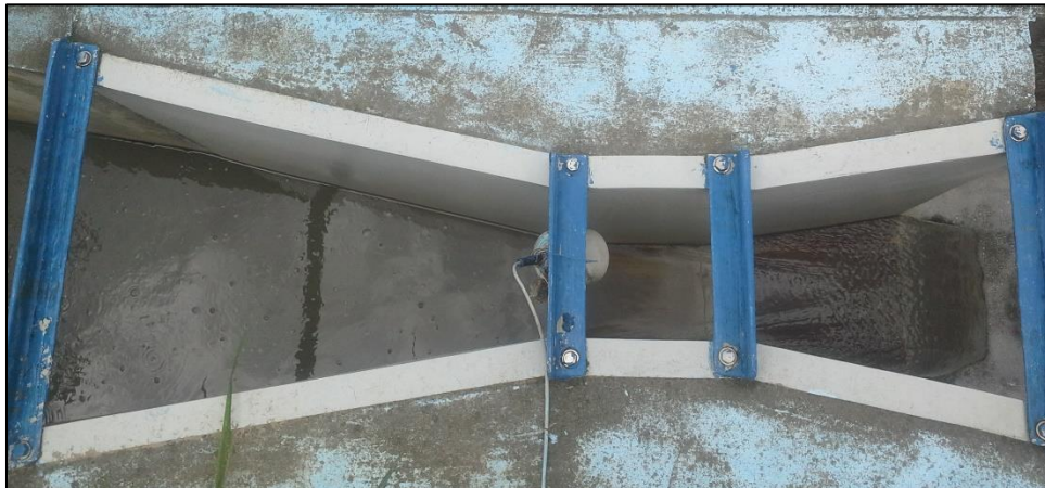
Figura 13. Fotografía canaleta Parshall
