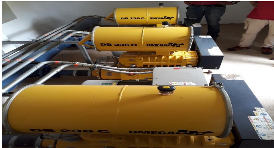
Figura 16. Fotografía sopladores de aire
