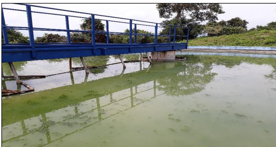
Figura 18. Fotografía tanque clarificador
