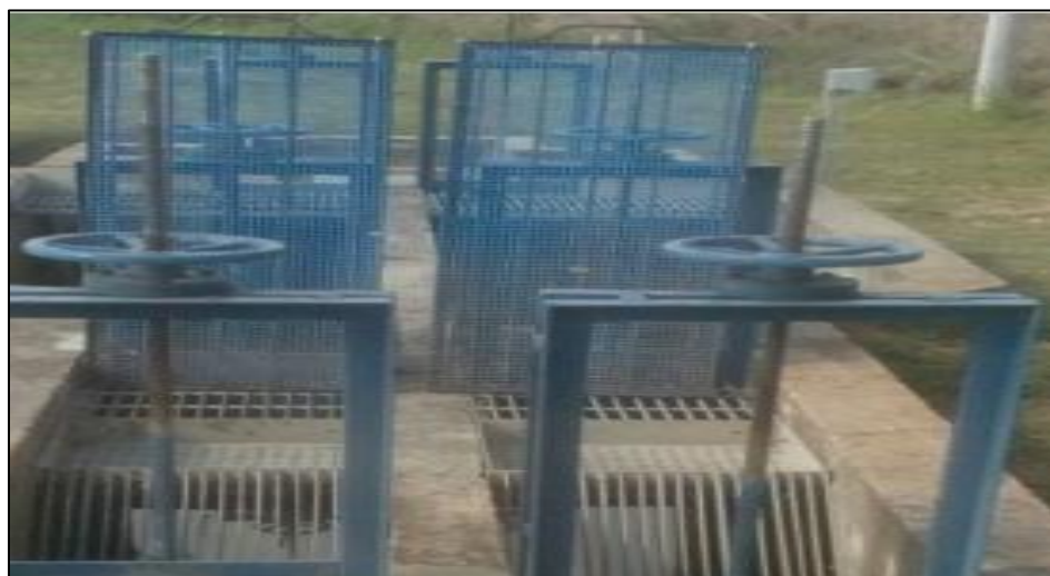
Figura 11. Fotografía canal de cribado
