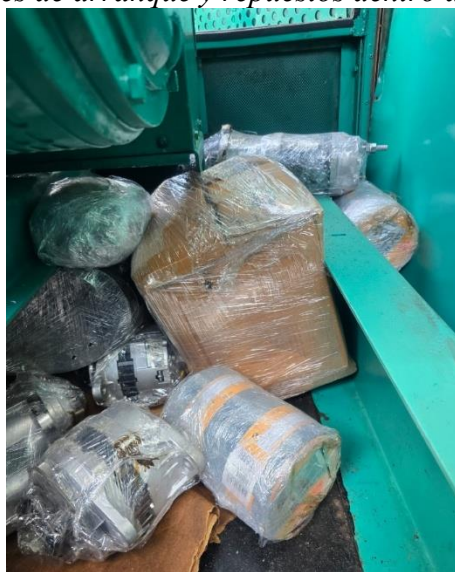
Figura 1. Alternadores, motores de arranque y repuestos dentro de un grupo electrógeno
