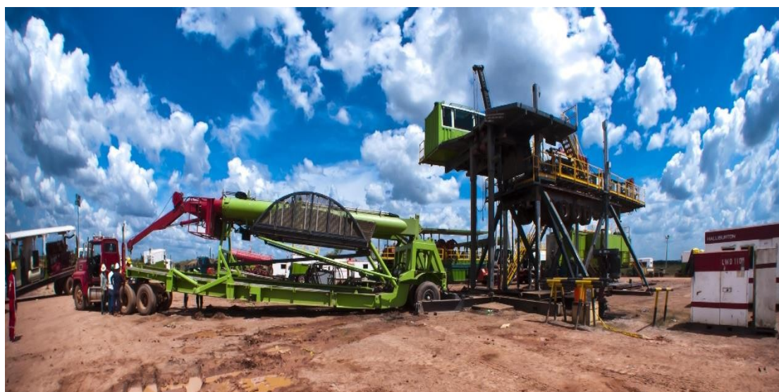
Figura 3 Instalación en territorio de Petroworks
