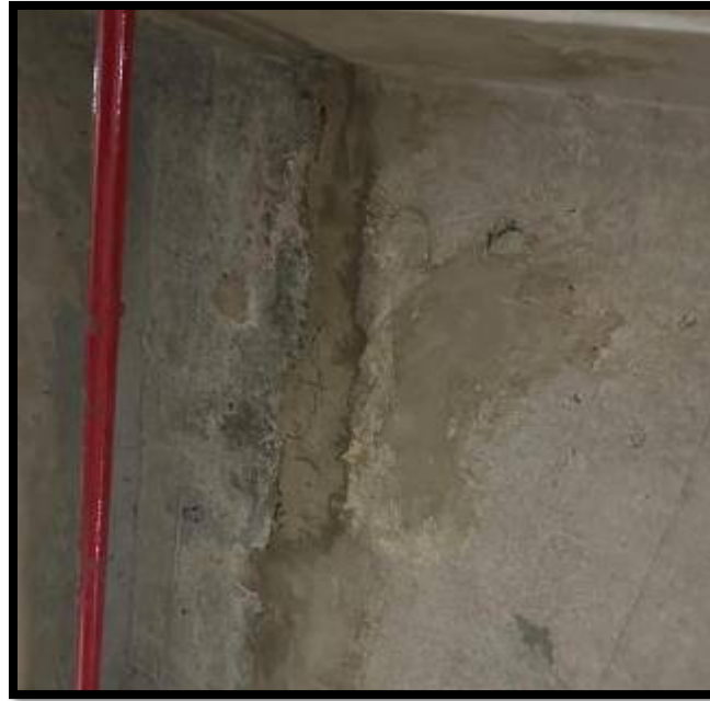
Ilustración 12. Zona con resanes con pañete (por los autores).
