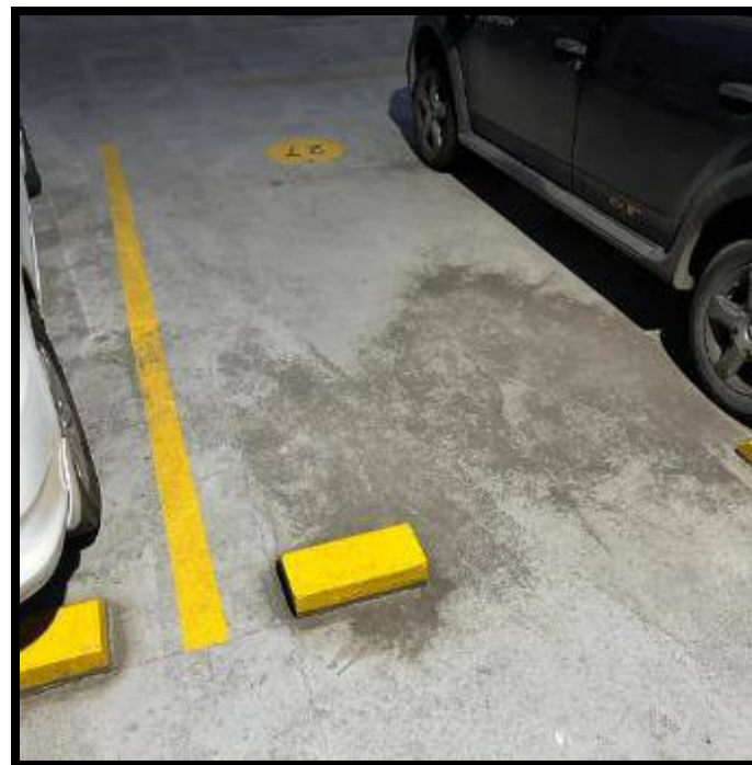
Ilustración 5. Humedad en losa superior (Por los autores).
