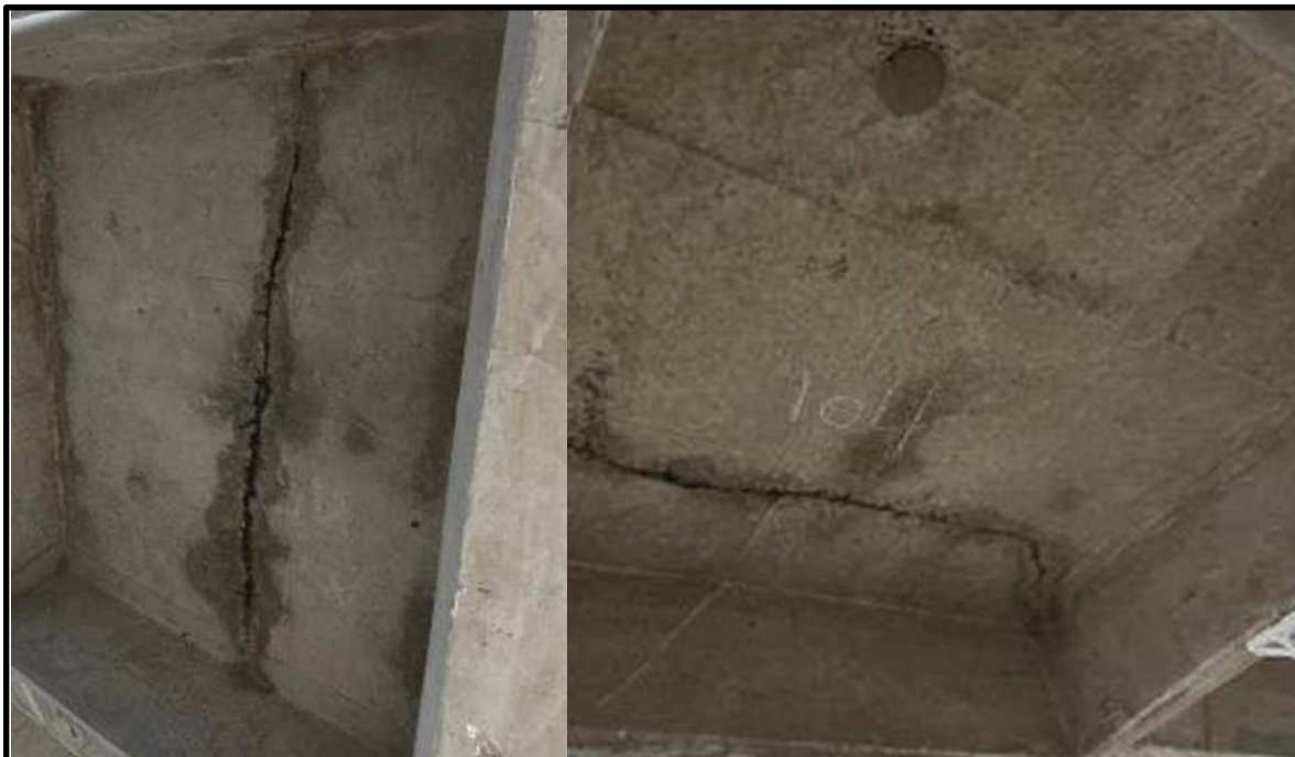
Ilustración 9. Aparente estado de falla en losa de entrepiso (Por los autores).
