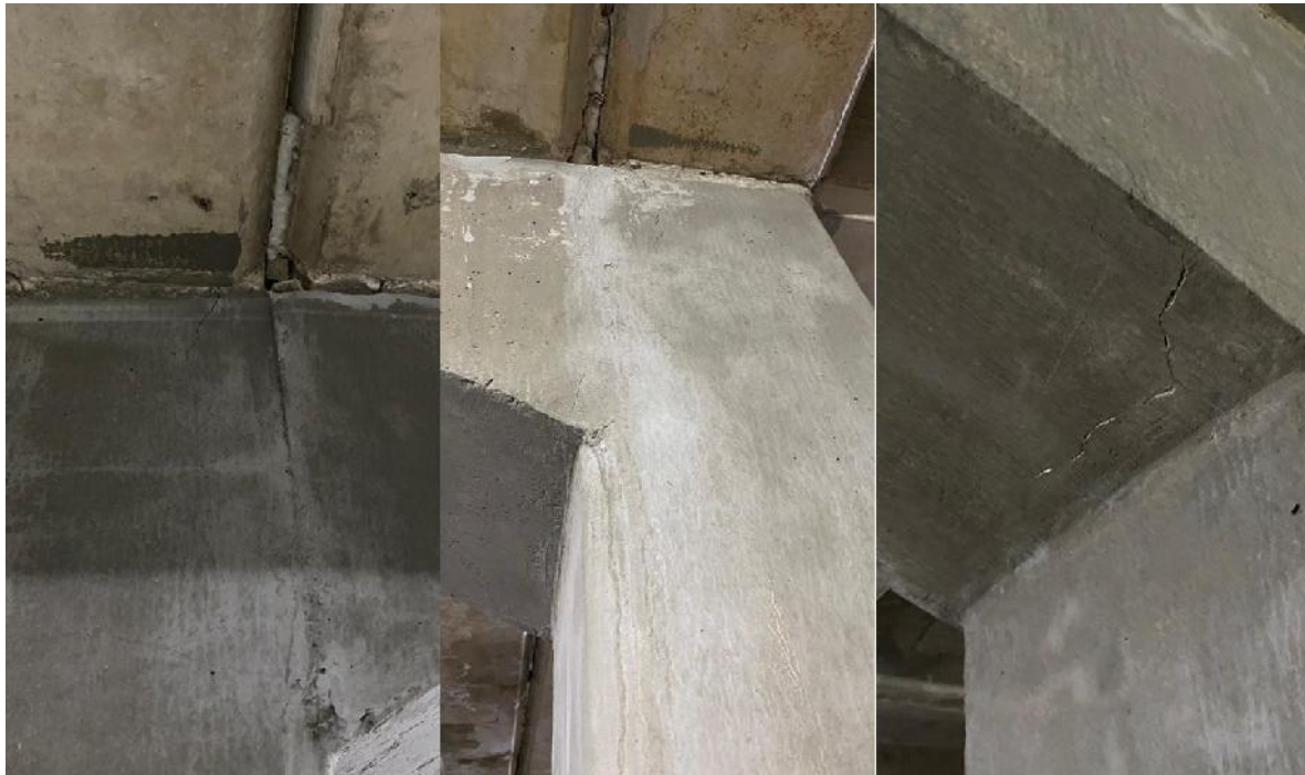
Ilustración 37 - Grietas identificadas en ménsulas de apoyo del entrepiso
