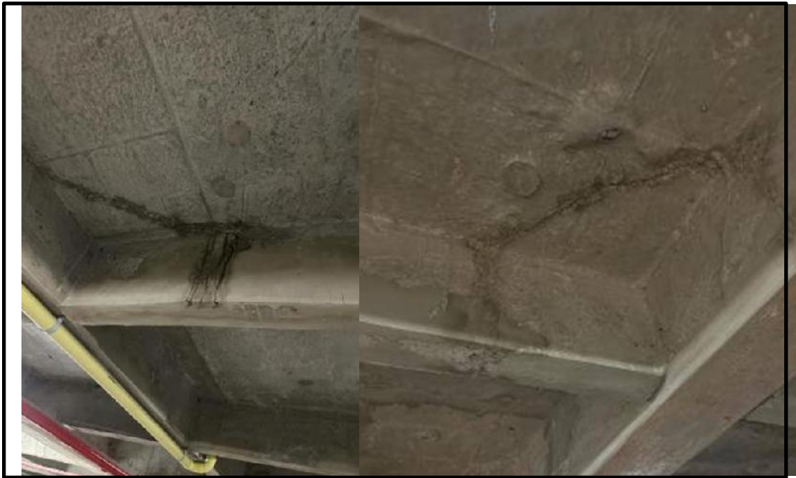
Ilustración 10. Fisuras evidenciadas en vigas (Por los autores).
