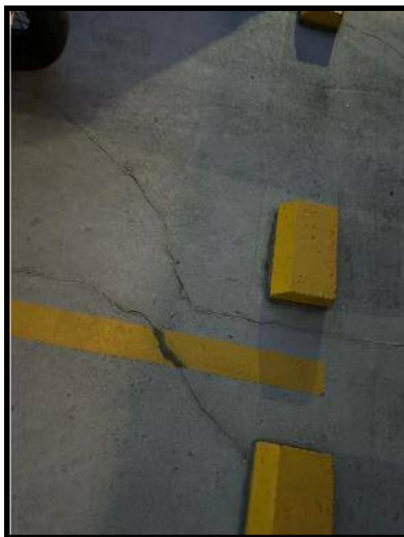
Ilustración 7. Zona con agrietamientos predominantes (Por los autores).
