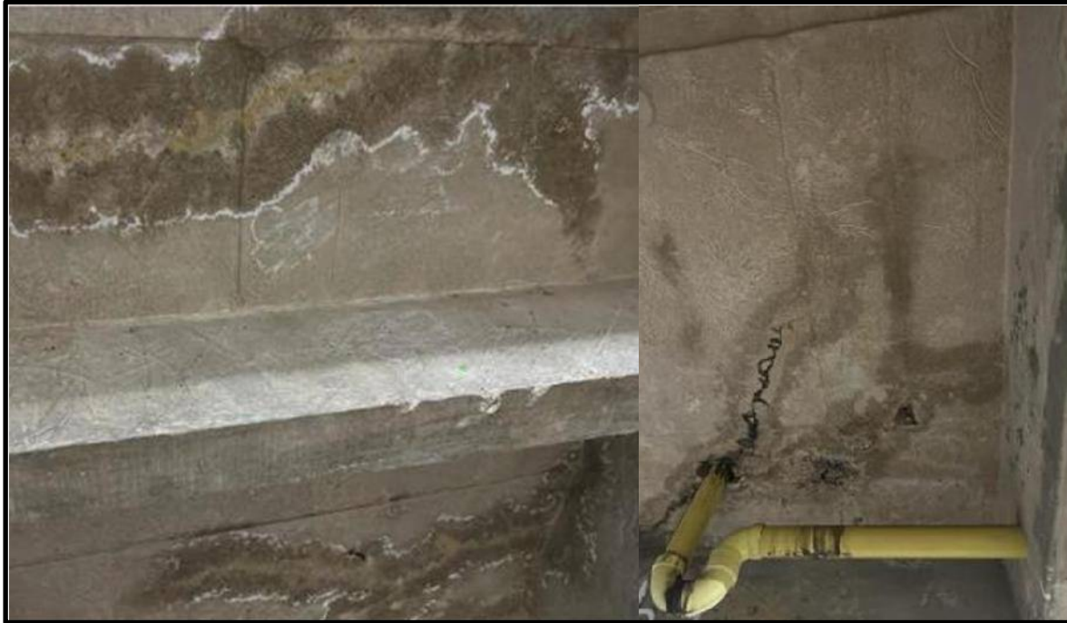
Ilustración 8. Humedades cara inferior losa de entrepiso (Por los autores).
