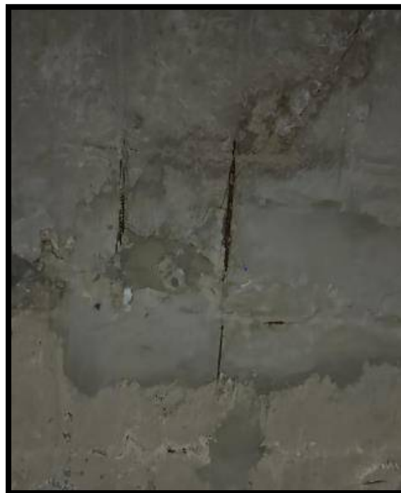
Ilustración 11. Ausencia de recubrimiento- Acero de refuerzo expuesto (por los autores).
