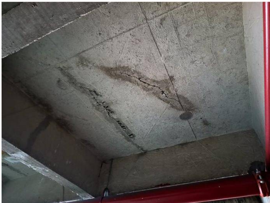
Ilustración 35. Fisuras en la losa maciza (Por los autores)
