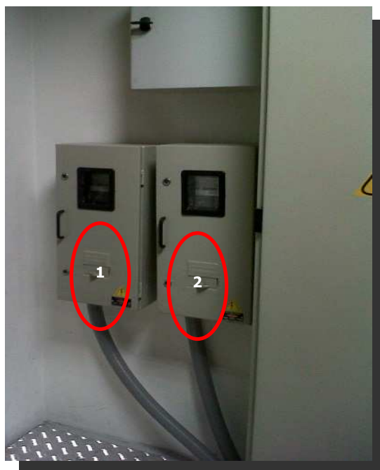
Figura 8. 1 - Medidor de Energía Trifásico Sobre Iluminación, 2- Medidor de Energía Trifásico Sobre Iluminación de Circulaciones
