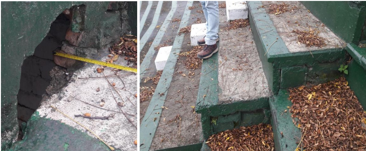
Imagen 33. Muro local 6 deteriorado
