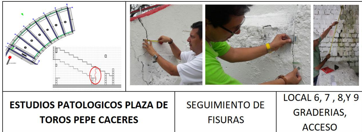
Imagen 22. Seguimiento de Fisuración.
