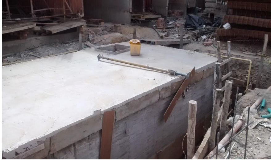
Fotografía 37. Tanque de almacenamiento
