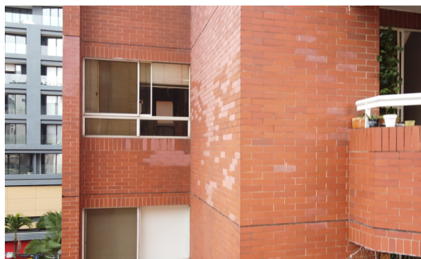
Ilustración 6. Desprendimientos de unidades de fachaleta (EMA, 2022).
