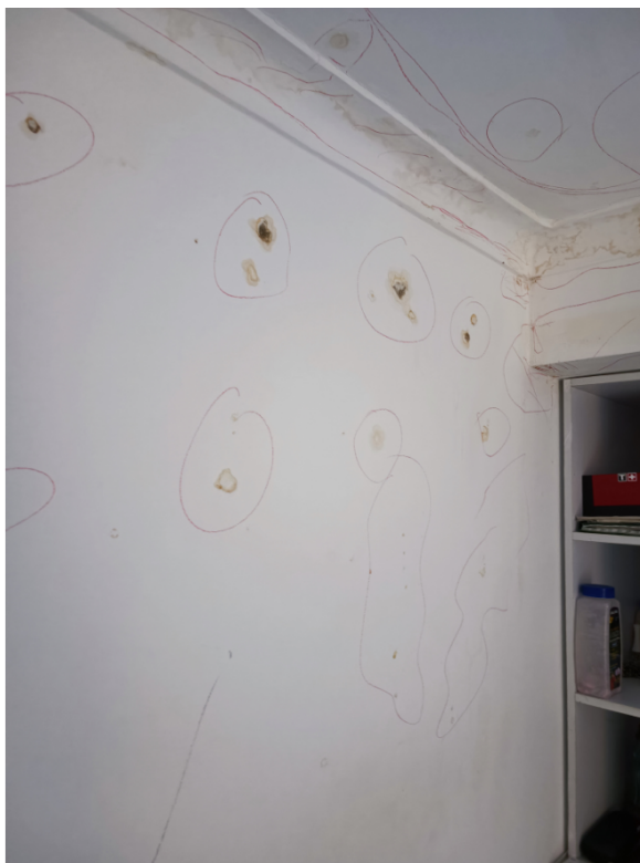
Ilustración 7. Lesiones en interior de muro de fachada Apartamento 702 (EMA, 2022)
