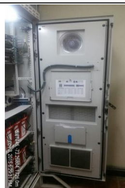
Foto 4. Frente de Gabinete
