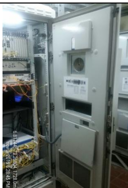
Foto 3. Frente de Gabinete
