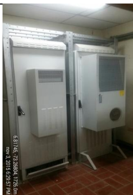
Foto 5. Frente de Gabinete
