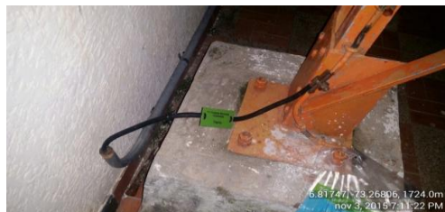
Foto 17. Sistema de Puesta a Tierra
