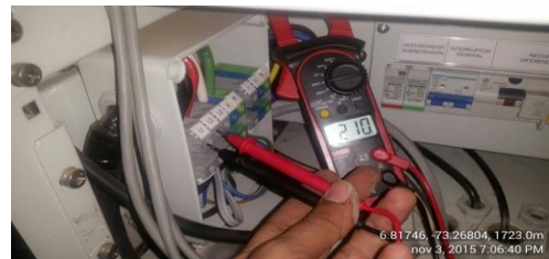
Foto 14. Entrada energia AC (Gabinete)
