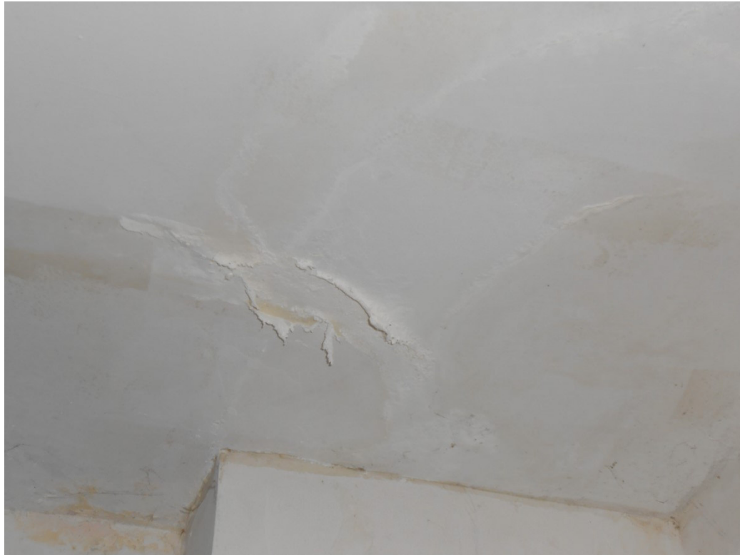
Figura. 23 fisuración y humedad en techo de administración
