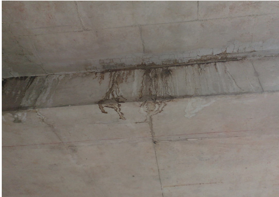
Figura. 18 fisuración y rastros de humedad en placa de entrepiso sótano 1
