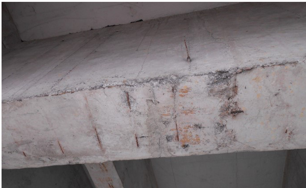
Figura. 29 Refuerzo expuesto y corroído - viga parqueadero
