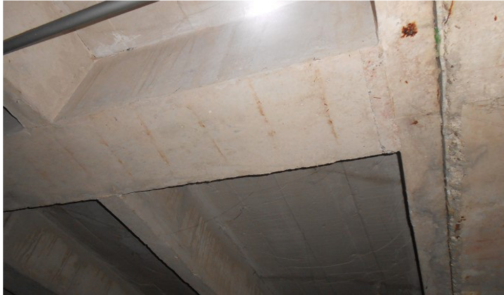
Figura. 28 Manchas de óxido en dirección del refuerzo a cortante – viga sótano 1.
