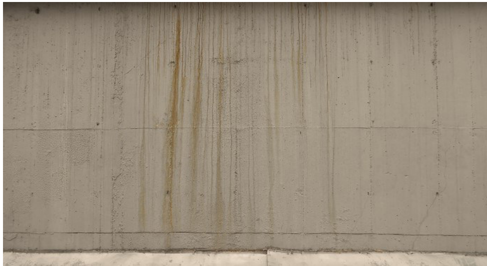
Figura. 25 Humedad por lavado diferencial muro perimetral de torre
