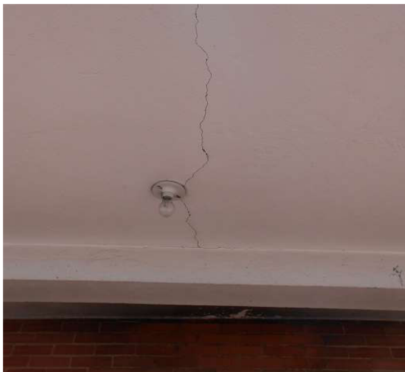
Figura. 22 fisuración techo de administración
