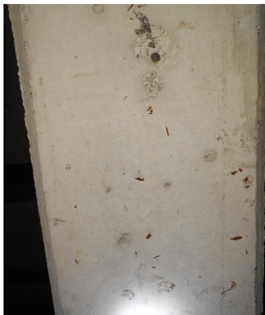
Figura. 31 Elementos de acero corroído en columna entre parqueaderos 124 y 125
