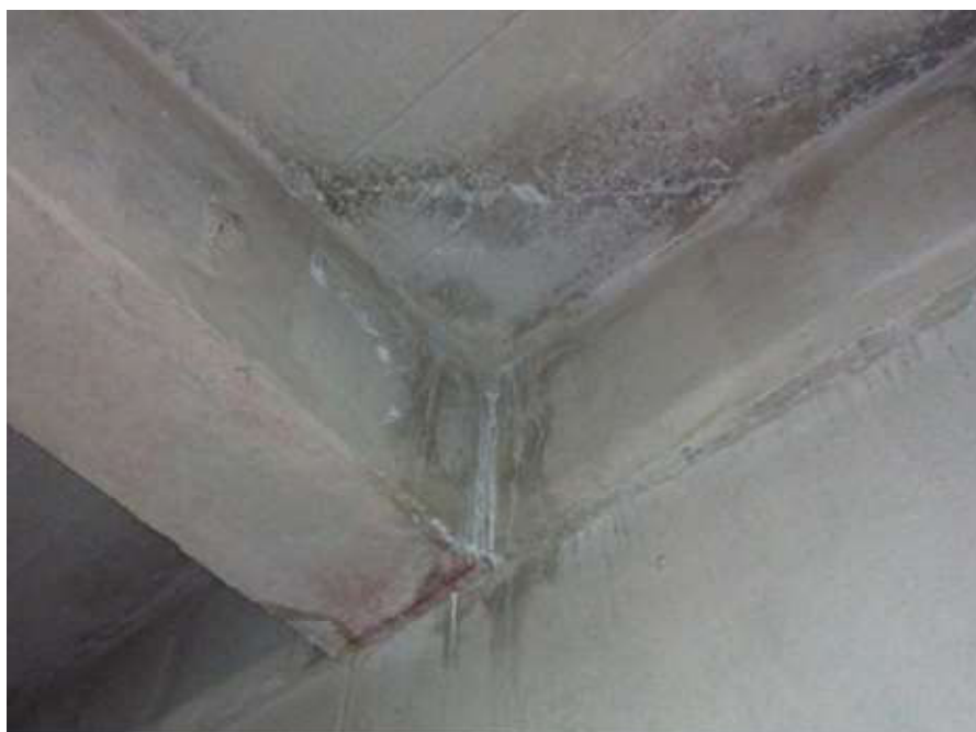
Figura. 27 Eflorescencia en viga sobre parqueadero 105
