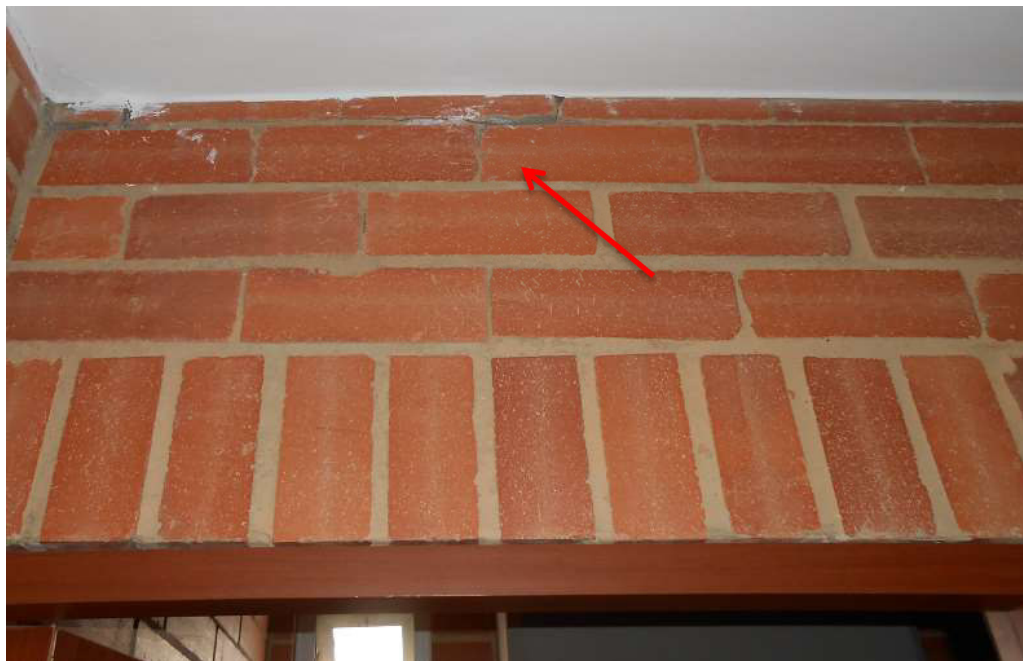
Figura. 21 fisuración en entrada de administración
