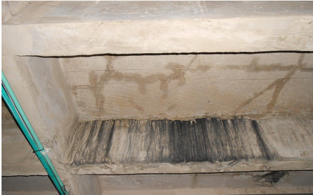
Figura. 24 Humedad por penetración de agua lluvia en placa de entepiso sótano 2
