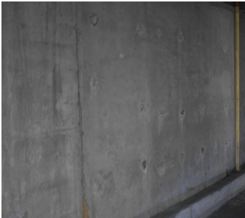
Figura. 39 Estado actual de muros de contención – pases o lloraderos sellados
