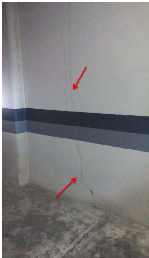
Figura. 17 fisuración en muro de contención sótano 1
