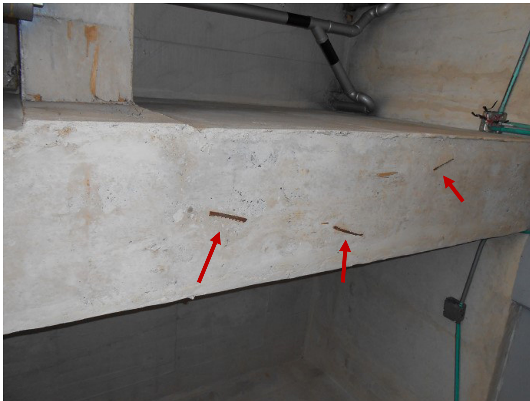
Figura. 30 Elementos de acero corroído en viga sobre parqueadero 52
