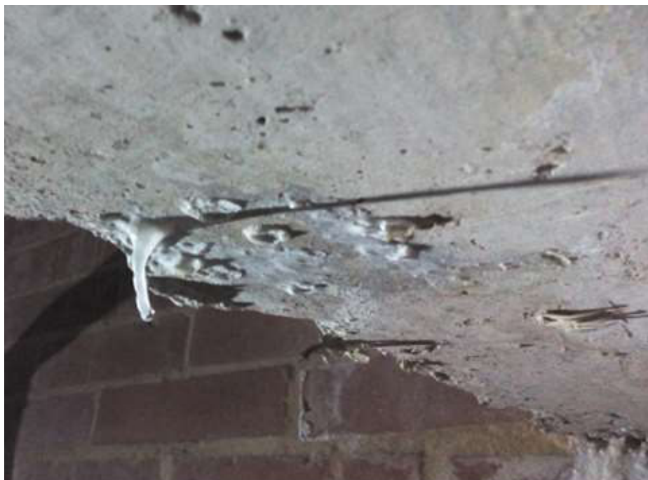
Figura. 26 Eflorescencia con goteo en placa de escalera
