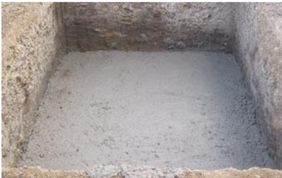
Fotografía 7. Concreto pobre para zapatas Fuente: Propia - 24 de septiembre de 2015
