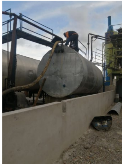
Figura 7.5 Planta de materiales asfálticos Pasolin S.A.S.
