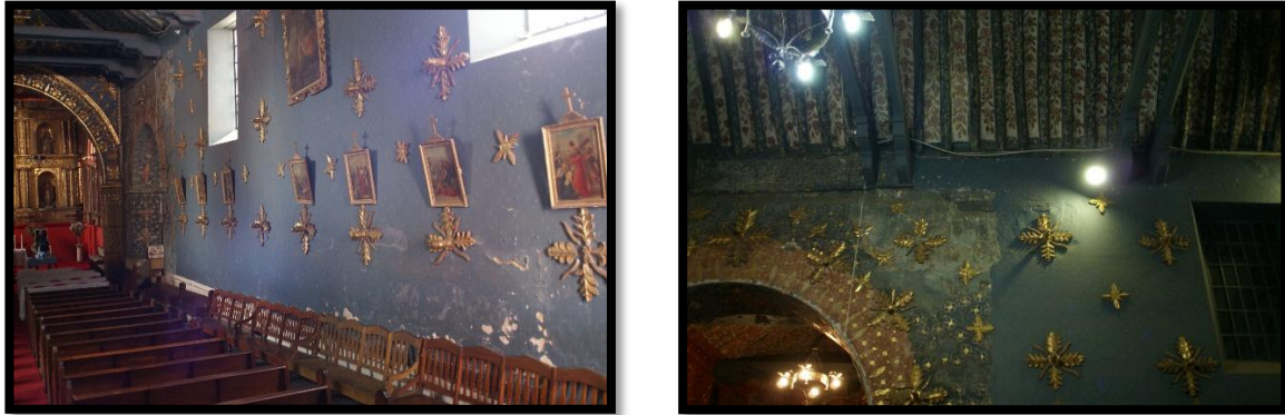
Figura 26. La humedad es constante, ante una intervención adecuada, para control de la capilaridad y de la humedad por condensación
