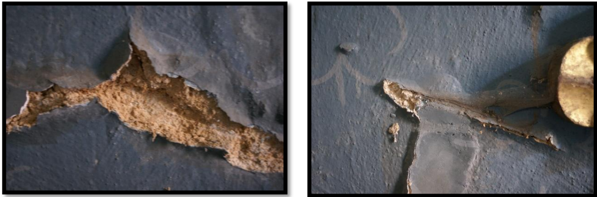
Figura 24. Desprendimiento de pañetes o repellos de cal y arena, por la presencia de la humedad
