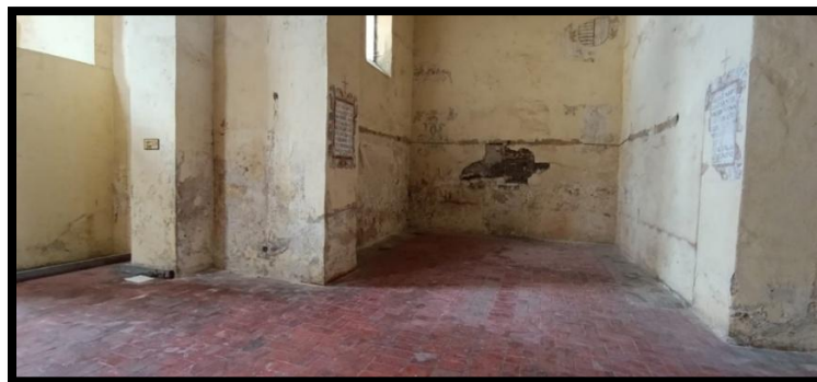
Figura 16. Humedad por acción de la capilaridad proveniente del subsuelo
