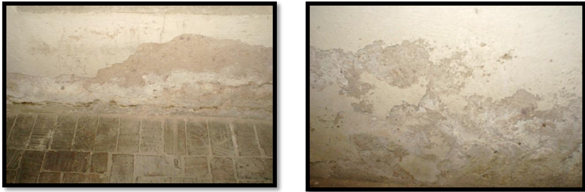
Figura 35. La humedad al interior se manifiesta en los muros compartidos con el jardín colindante
