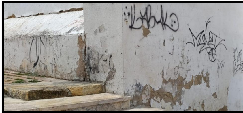
Figura 12. Detalle afectación por capilaridad en fábrica de tierra, humedad ascendente hasta el nivel del zócalo y salpicadura de aguas lluvias. Iglesia de San Francisco. BIC. Tunja
