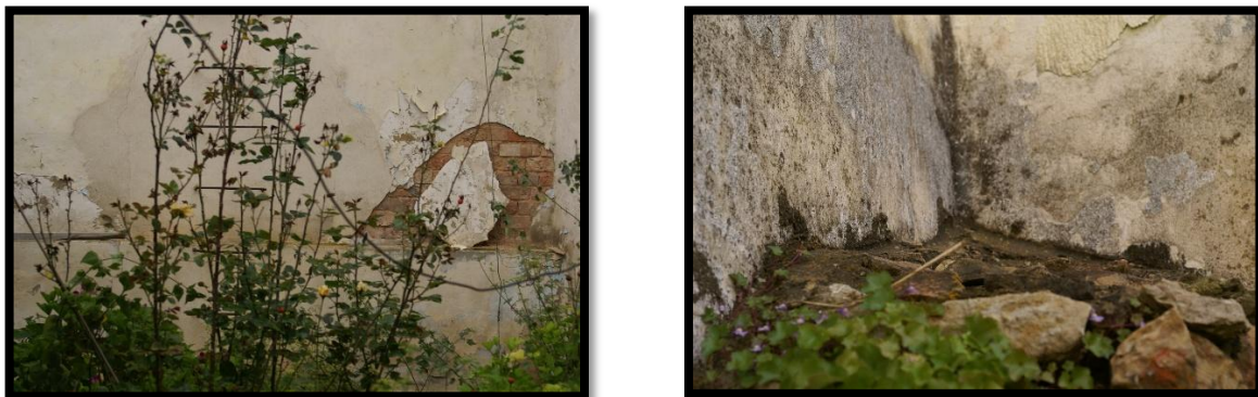
Figura 34. La humedad proveniente de jardines que afectan la fábrica de tierra y sus cimientos como sobrecimientos, transfieren humedad al interior del templo por capilaridad
