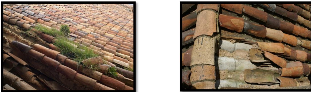
Figura 33. Deterioros en la cubierta, permitiendo el ingreso de aguas lluvias al interior del templo, generando goteras o humedades descendentes
