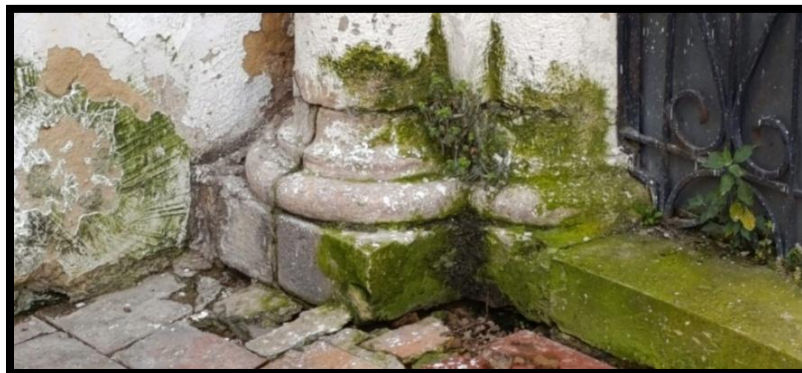
Figura 11. Detalle afectación por humedad. Convento de San Francisco. (BIC). Tunja
