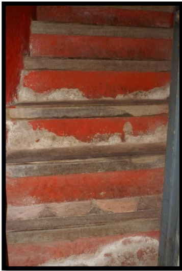
Figura 31. Afectaciones en escaleras contra muros
