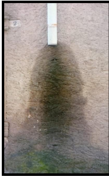
Figura 21. Humedad descendente, por deficiente bajante de aguas lluvias, ocasionando deterioros en la fachada y al interior del muro
