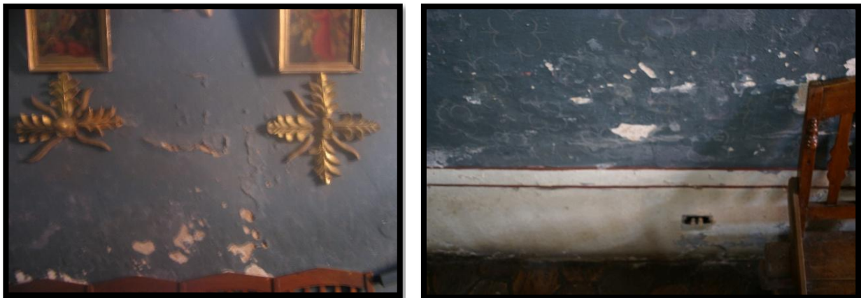
Figura 25. En general la fábrica de tierra del templo, en tapia pisada y adobe, son afectadas por la humedad ascendente. Arrastrando sales del subsuelo.
