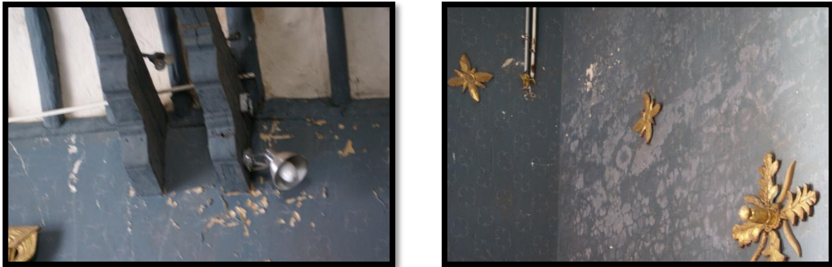
Figura 27. Humedad por condensación
