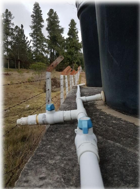
Tuberías y conexiones de tramos externos:
