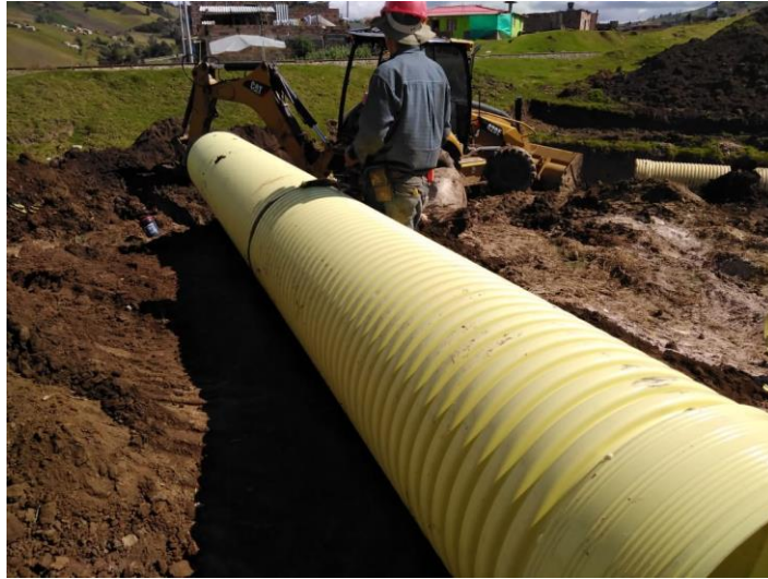
Imagen 9. Tubería corrugada en PVC de 20 pulgadas
