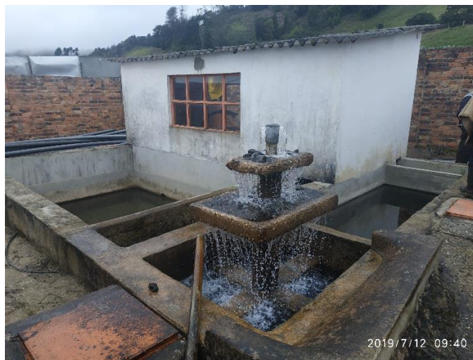
Imagen 13. Ptap tanques en concreto tipo 1
