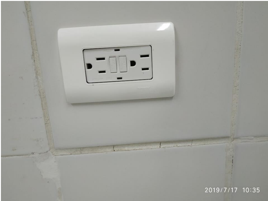
Imagen 3. Toma corriente GFCi
