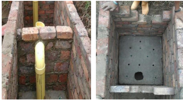
Fotografía 23 Tanque séptico y trampa de grasas
