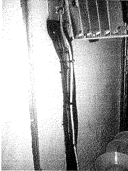
Figura 78. Cableado en mazo Estación Operador de Video
