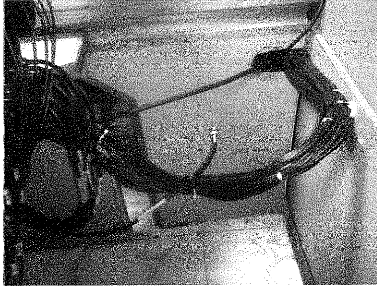
Figura 50. Cableado en mazo de la Consola Yamaha 02R96V2 Cabina de Audio
