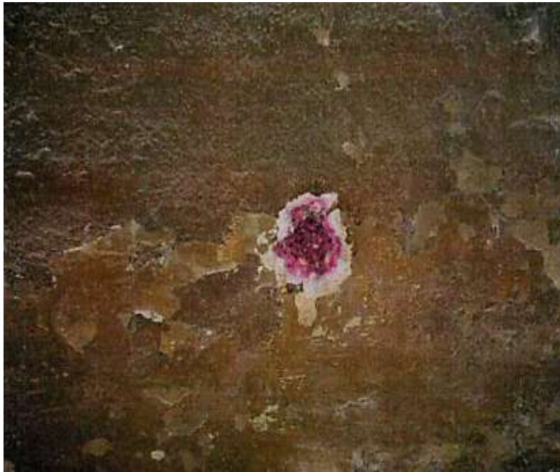
Pruebas para determinar la profundidad del frente de carbonatación de las paredes del tanque
