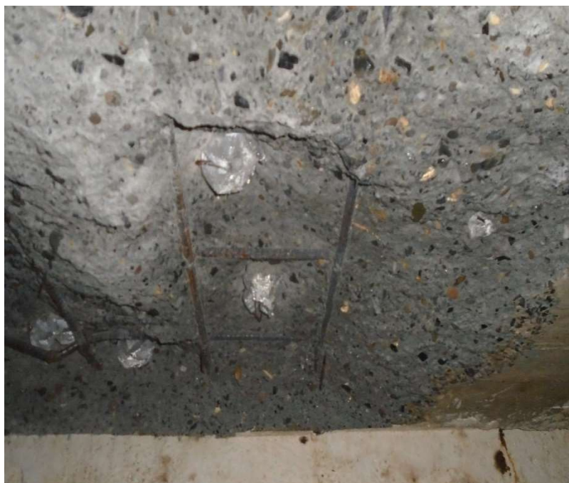
Figura 17. Acero de refuerzo expuesto, poco recubrimiento y pérdida de concreto. Fuente:
