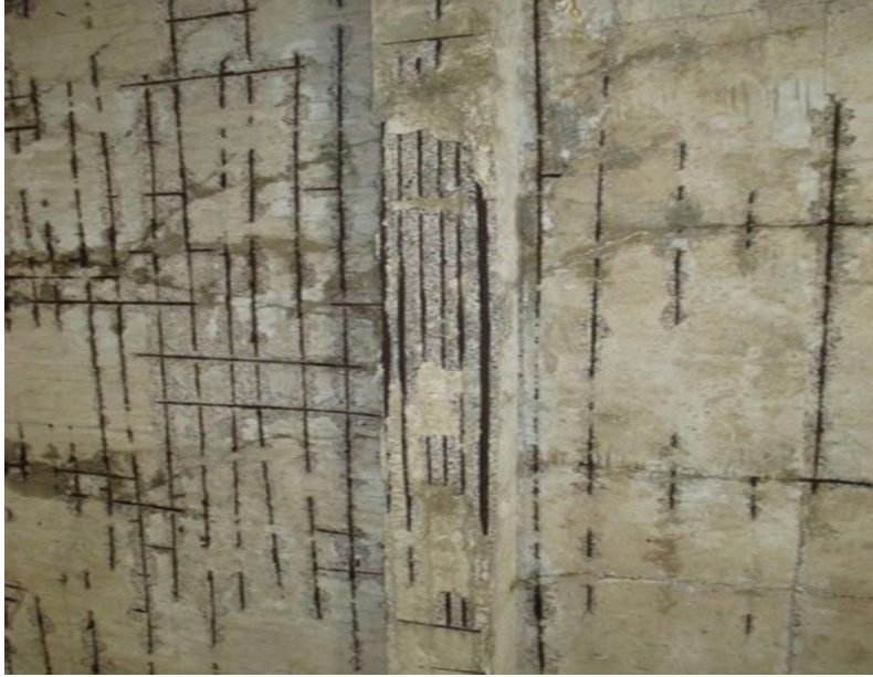
Aceros de refuerzo expuestos y corroídos en las paredes del tanque
