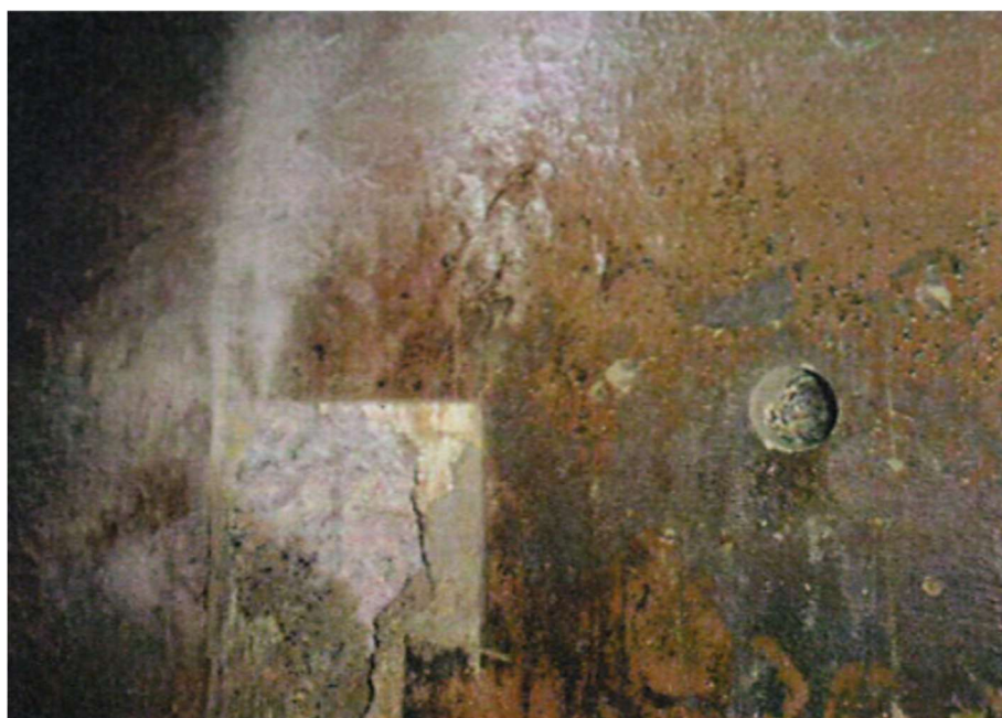
Figura 18. Degradación de la superficie del concreto por efectos químicos en las paredes del tanque. Fuente: Elaboración propia.
