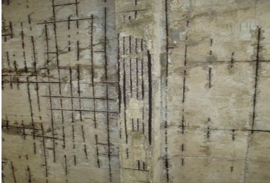
Figura 19. Aceros de refuerzo expuestos y corroídos en las paredes del tanque. Fuente:
