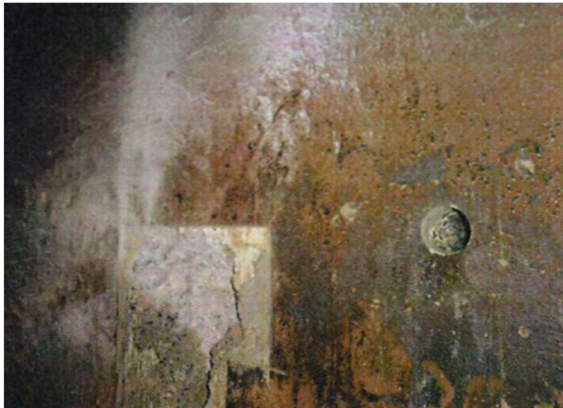
Degradación de la superficie del concreto por efectos químicos en las paredes del tanque
