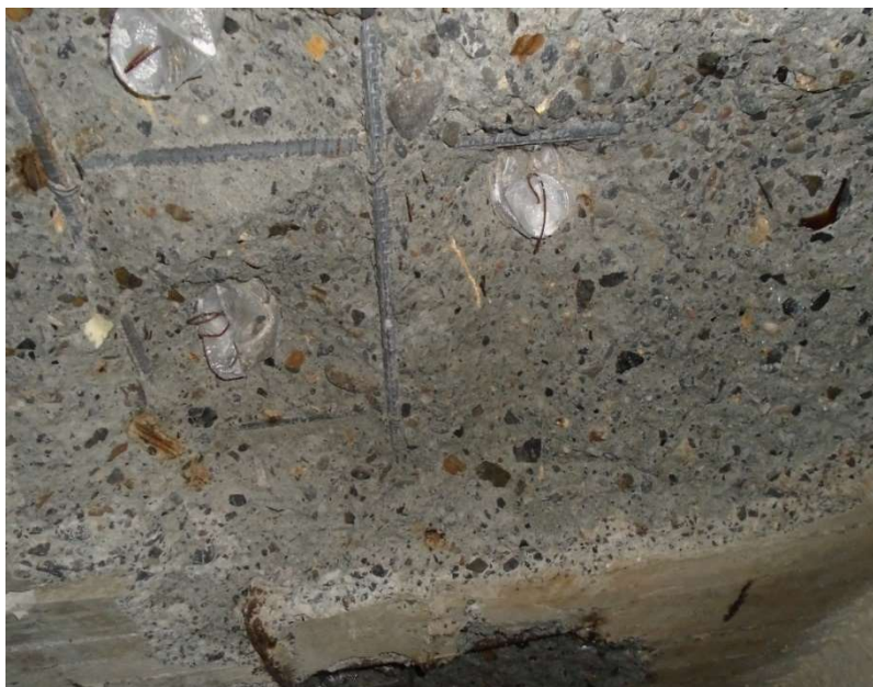
Figura 16. Acero de refuerzo expuesto, poco recubrimiento y pérdida de concreto. Fuente:
