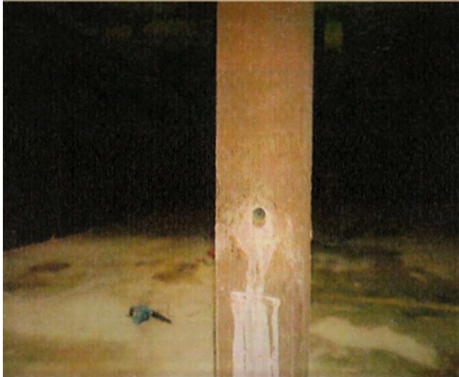
Figura 21. Se observan las columnas del tanque en buen estado. Fuente: Elaboración propia.
