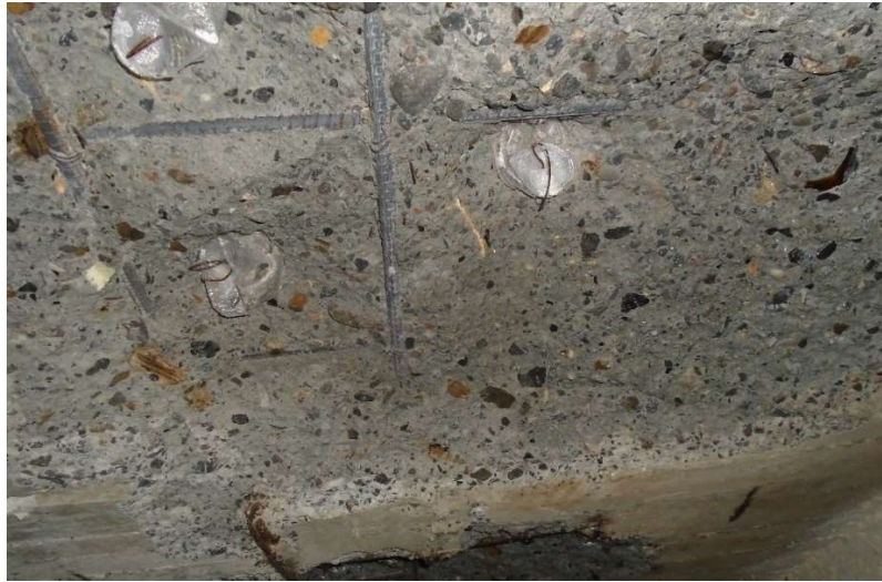
Acero de refuerzo expuesto, poco recubrimiento y pérdida de concreto
