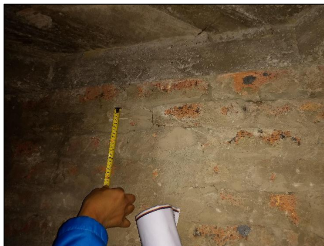
Figura 25. Agrietamientos por aplastamiento.
