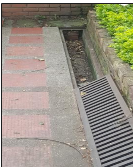
Figura 9. Estado de drenajes del sector costado occidental.
