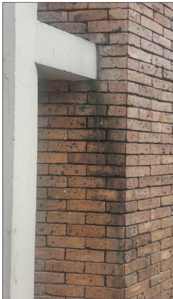
Figura 31. Suciedad por lavado diferencial en fachadas de la construcción.
