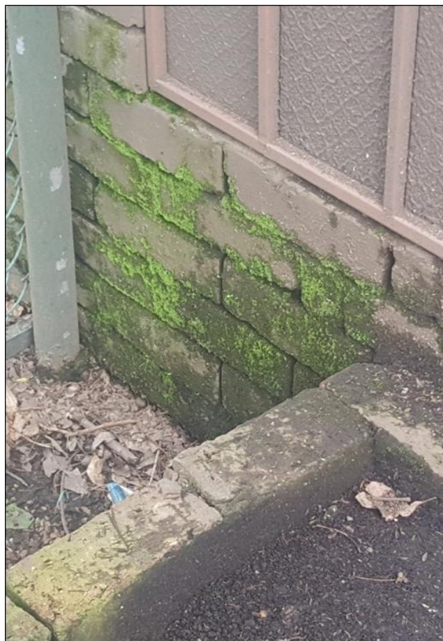
Figura 29. Humedad por capilaridad.
