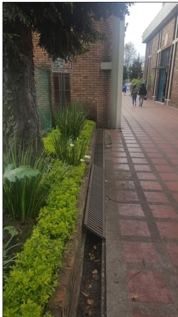
Figura 23. Fallo de sumidero.
