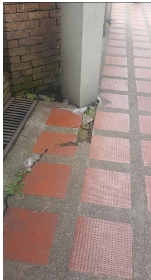
Figura 21. Agrietamiento en espacio público.
