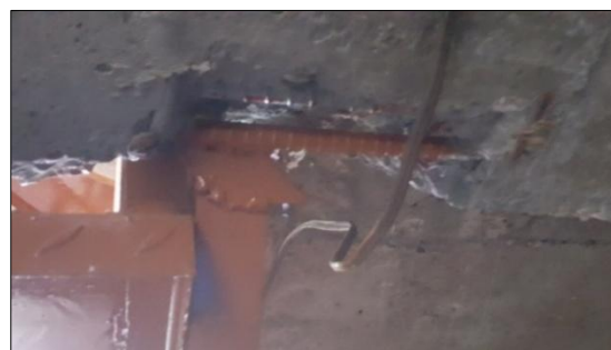
Figura 27. Desprendimientos de concreto.
