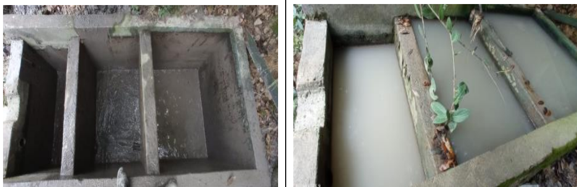
Figura 11. Sistema de tratamiento de agua residual minera
